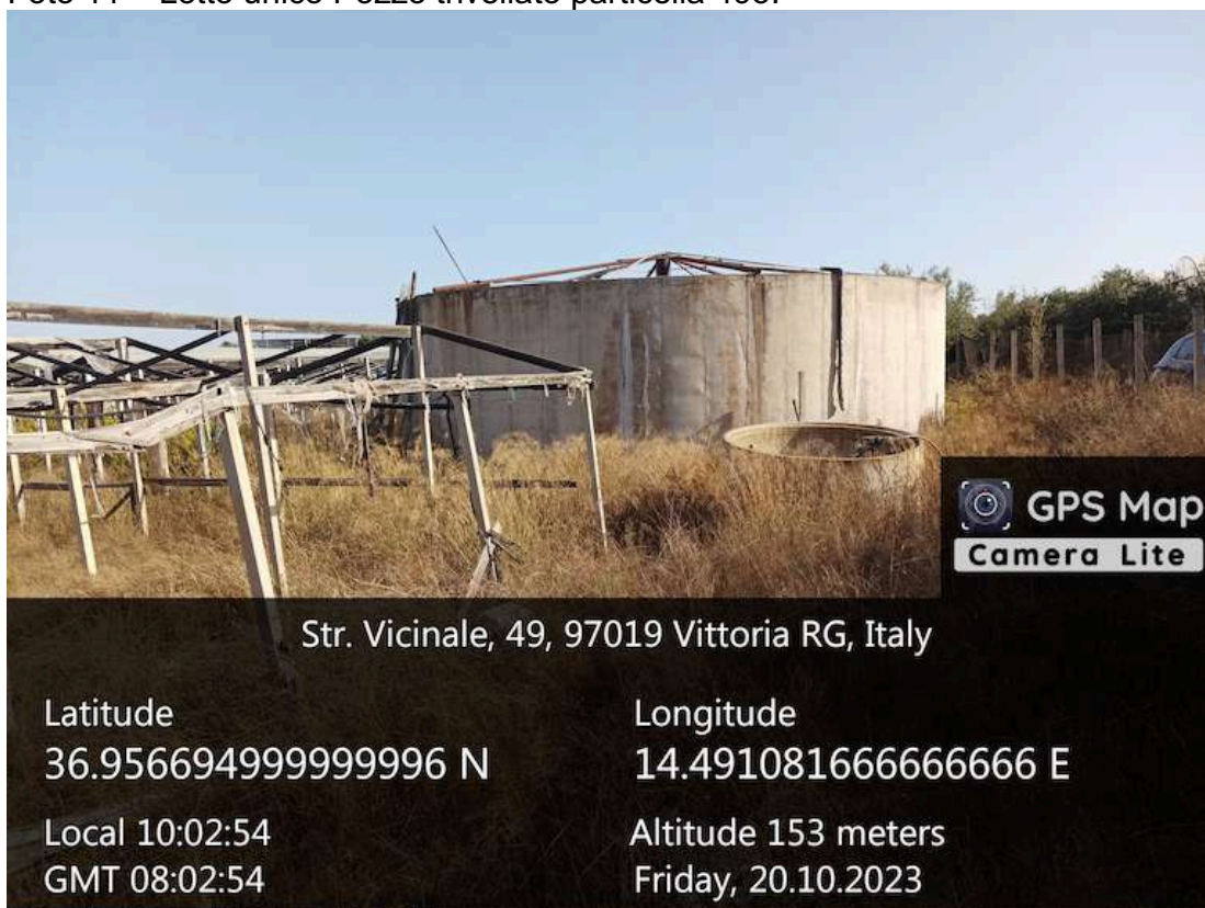
Foto 12 – Lotto unico Pozzo artesiano e Vasca accumulo particella 497.
