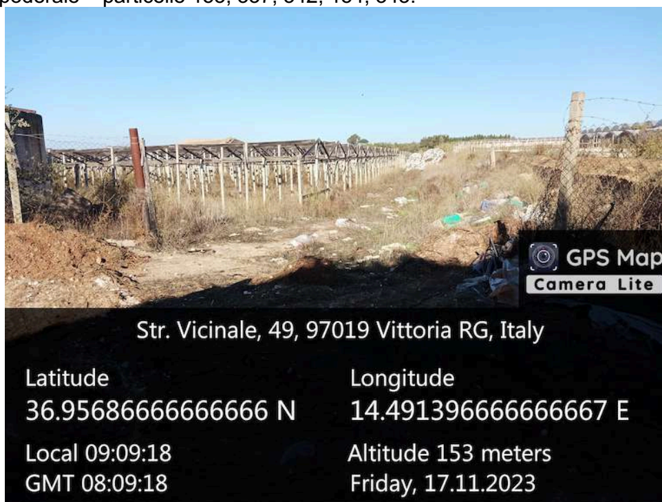
Foto 28 – Varco aperto nella recinzione tra la particella 495 e la 343.
