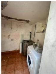
Foto 14. Vista interna locale tecnico
