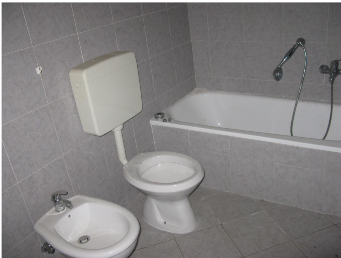
Foto 21 – Bagno seconda camera al piano terreno
