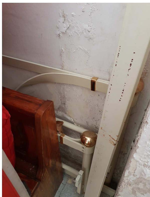
Danni provocati da infiltrazione d'acqua
