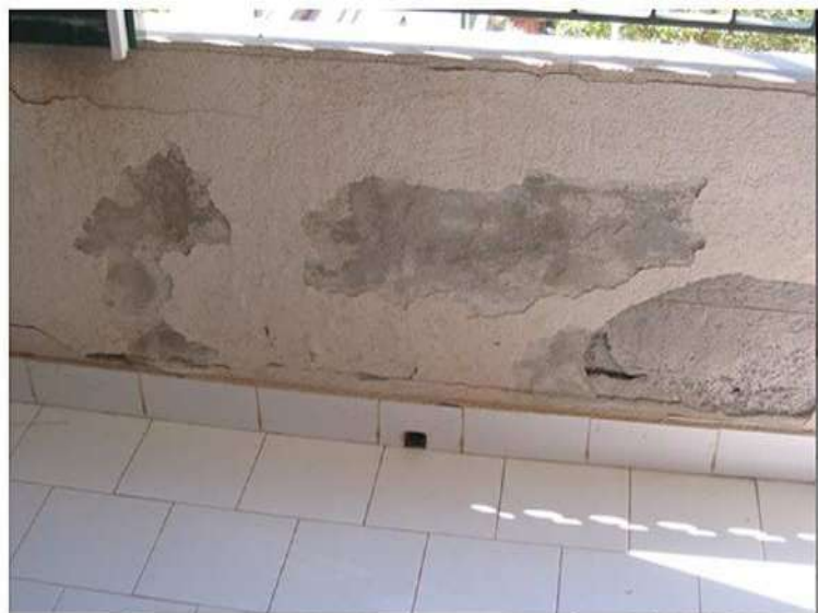
DETTAGLIO AMMALORAMENTO SUPERFICIE MURATURA INTERNA PARAPETTO
