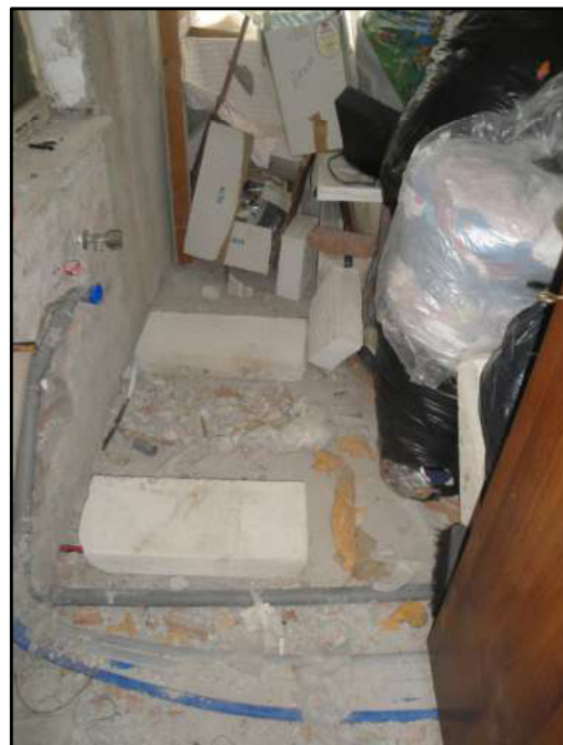
FOTO N. 13 BIS BAGNO IN CAMERA NON REALIZZATO
