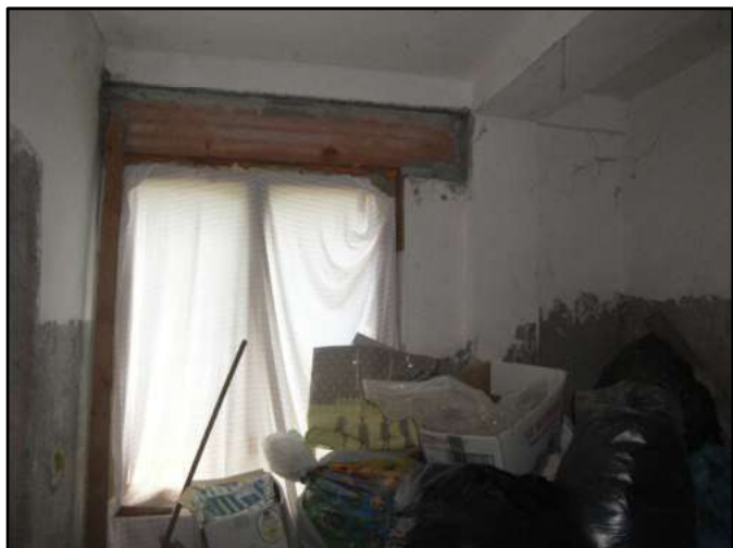
FOTO N. 13 BAGNO IN CAMERA 1 NON REALIZZ.
