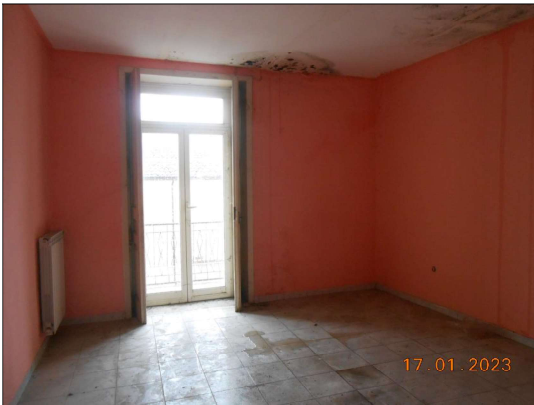
FOTO N. 43 Vista interna del piano primo. Si notano diffuse infiltrazioni sul soffitto e l'acqua sul pavimento
