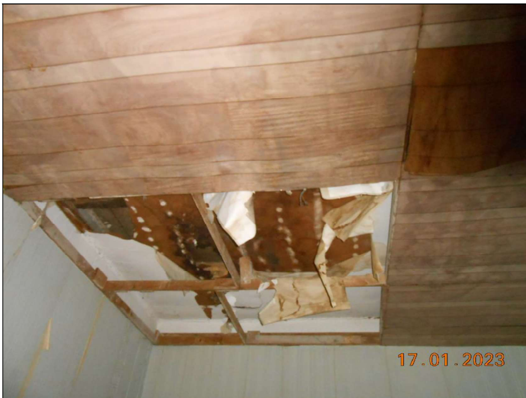
FOTO N. 41 Vista interna del piano primo. Si nota la controsoffittatura dei solai e le diffuse infiltrazioni.
