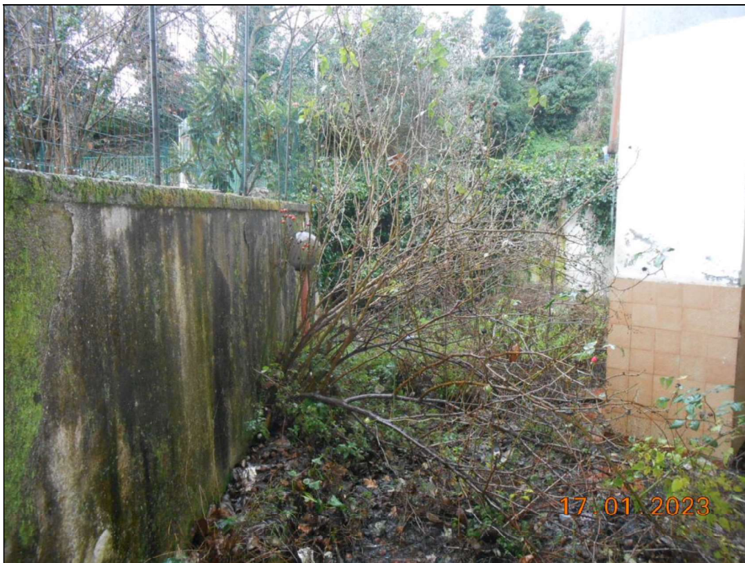
FOTO N. 34 Vista della corte pertinenziale p.la 421. Si nota lo stato di degrado.
