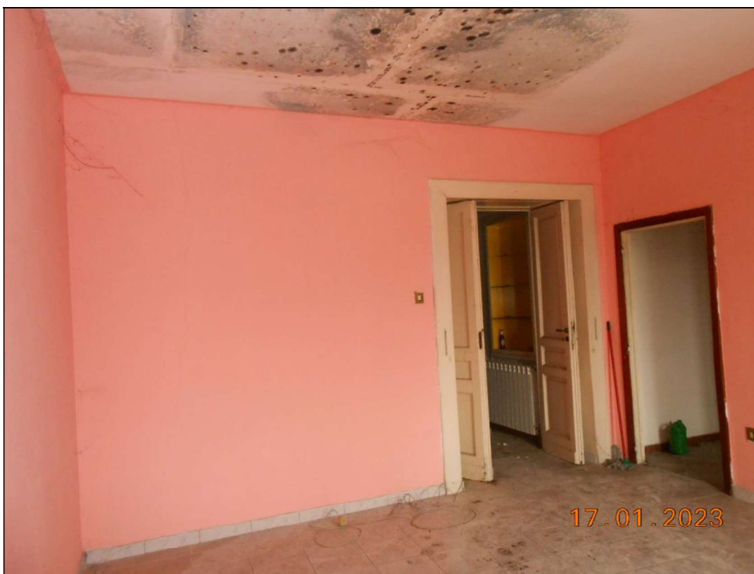
FOTO N. 42 Vista interna del piano primo. Si notano le diffuse infiltrazioni d'acqua sul soffitto
