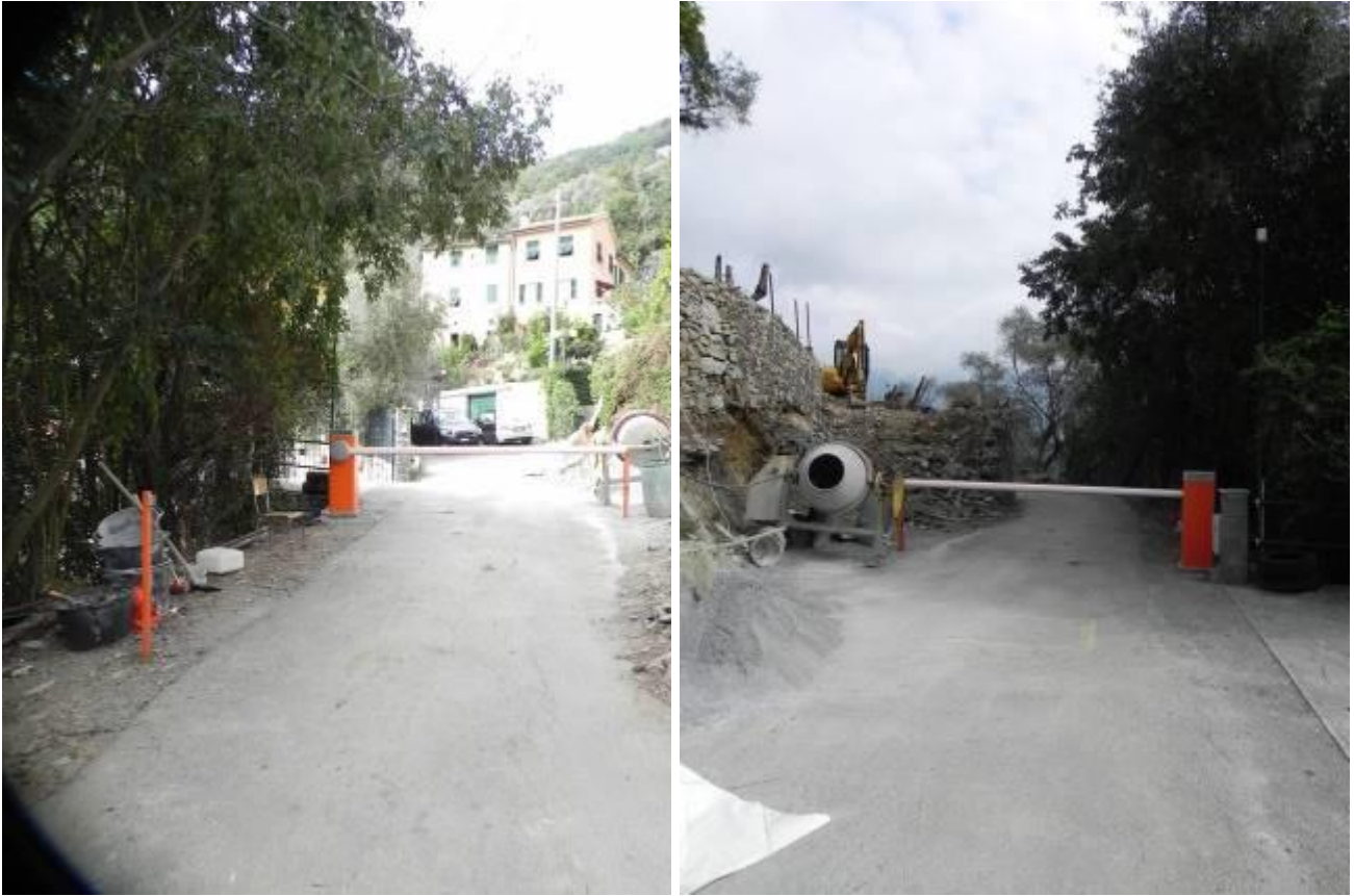
Foto 81 e 82 – Vista della strada carraia di Via Passalacqua in corrispondenza del punto in cui il “Comitato di zona” ha posizionato una barra di accesso carraio azionata da una pulsantiera alfanumerica.
