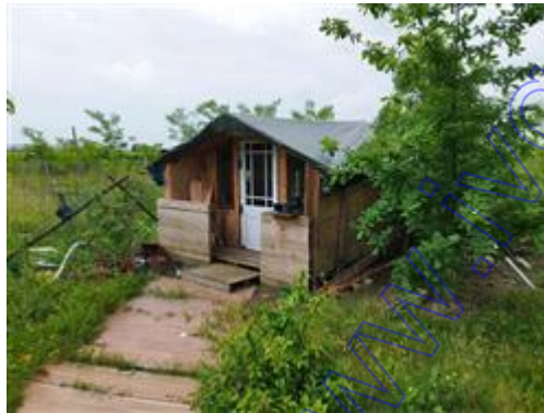
casetta in legno non autorizzata
