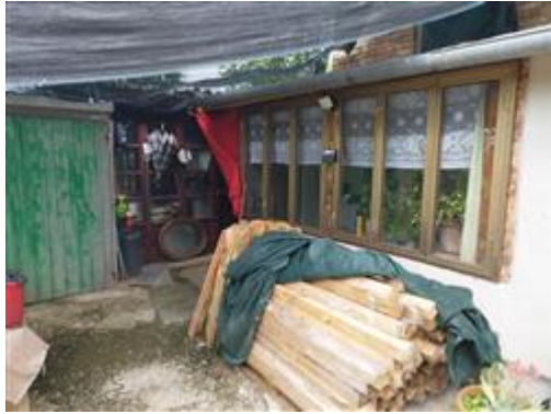
tettoie ampliamenti non autorizzati
