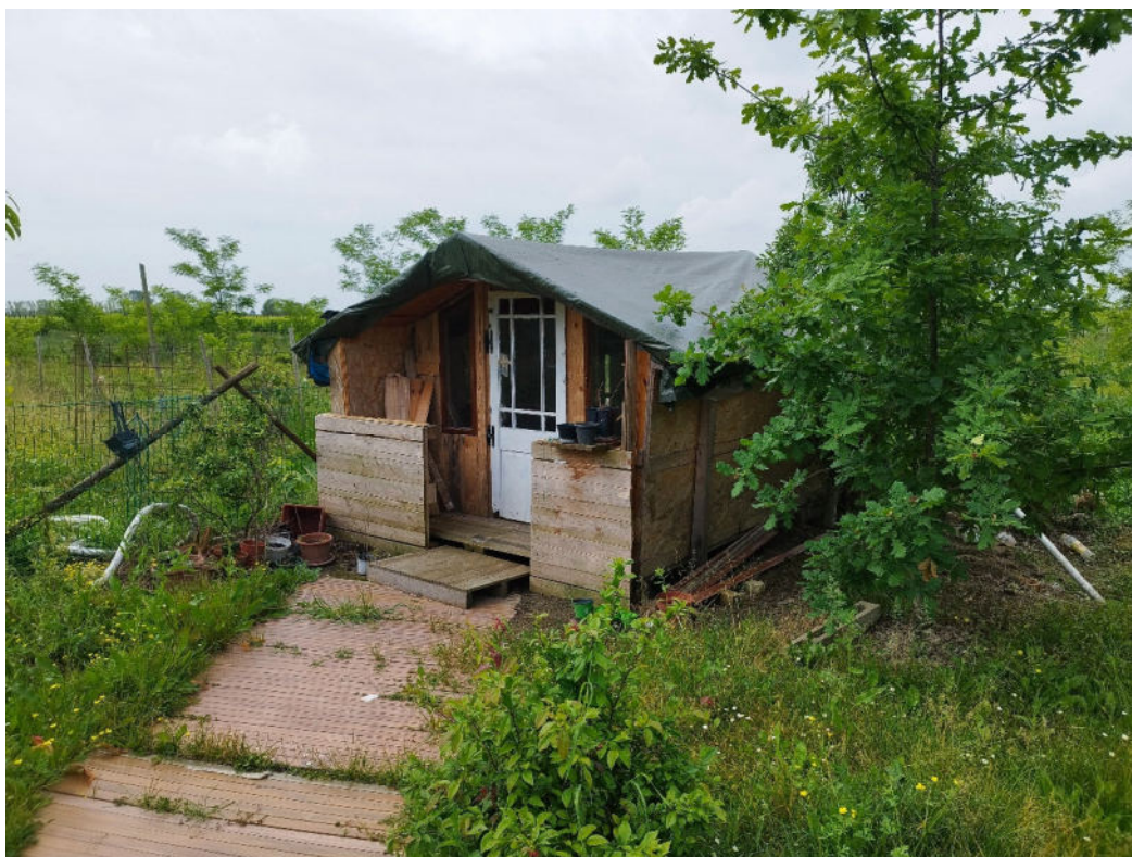
Particolare casetta abusiva su corte pertinenziale
