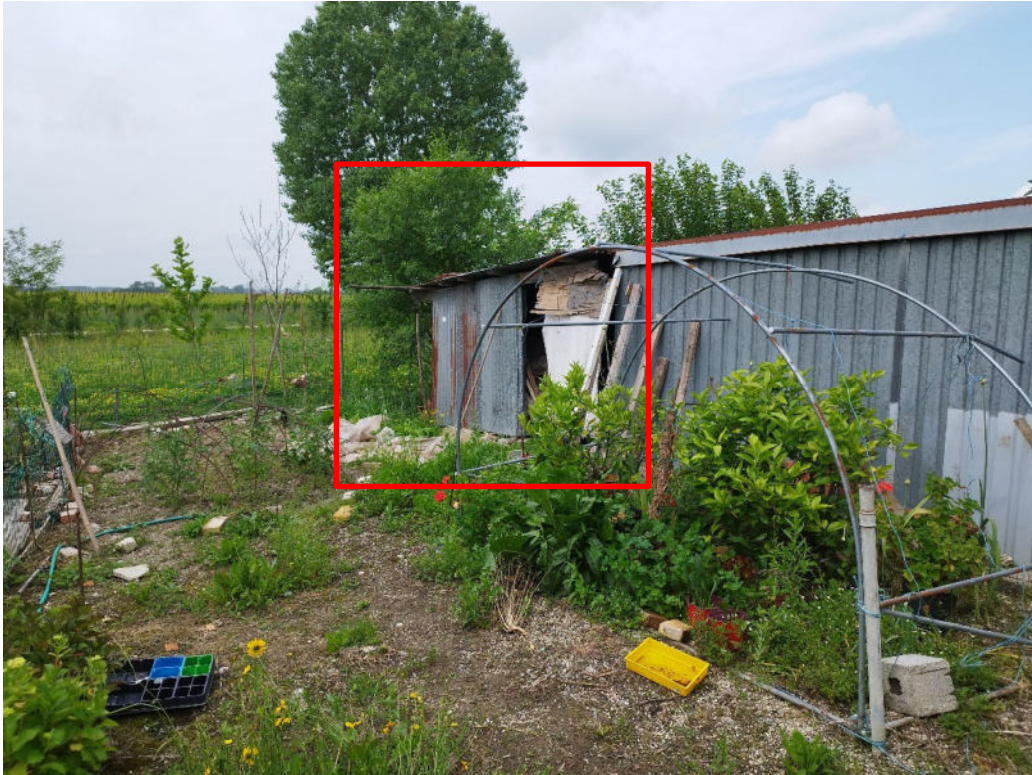
Particolari manufatti abusivi
