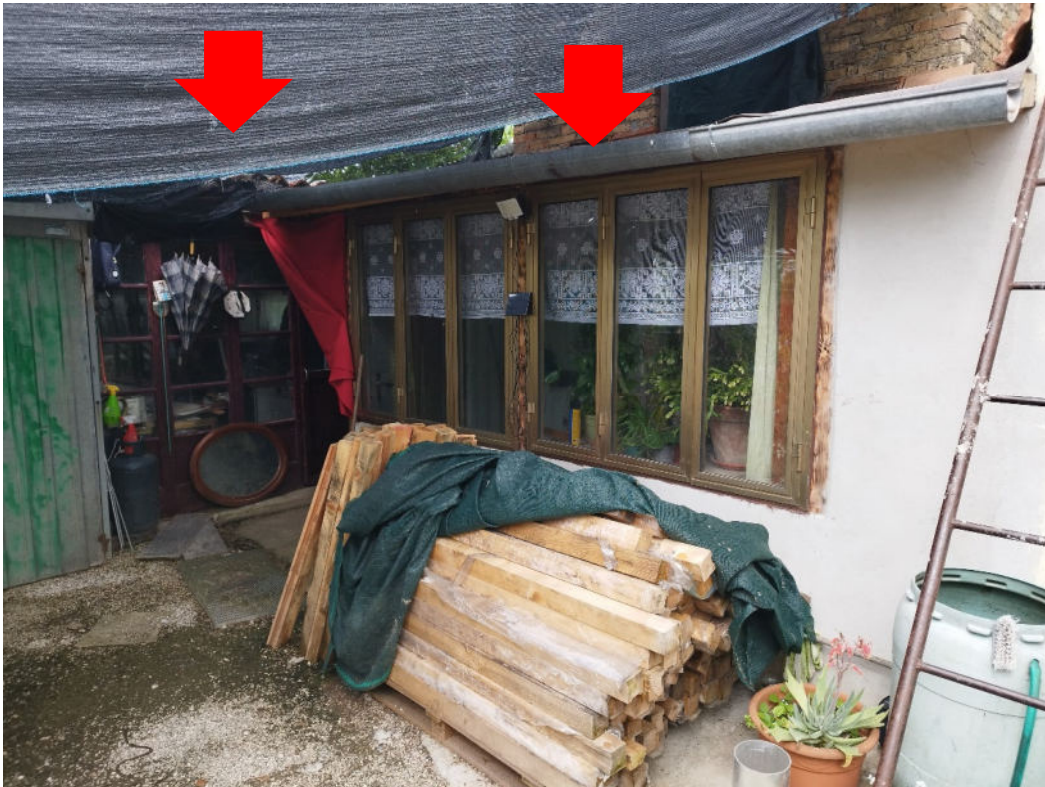
Particolari manufatti abusivi
