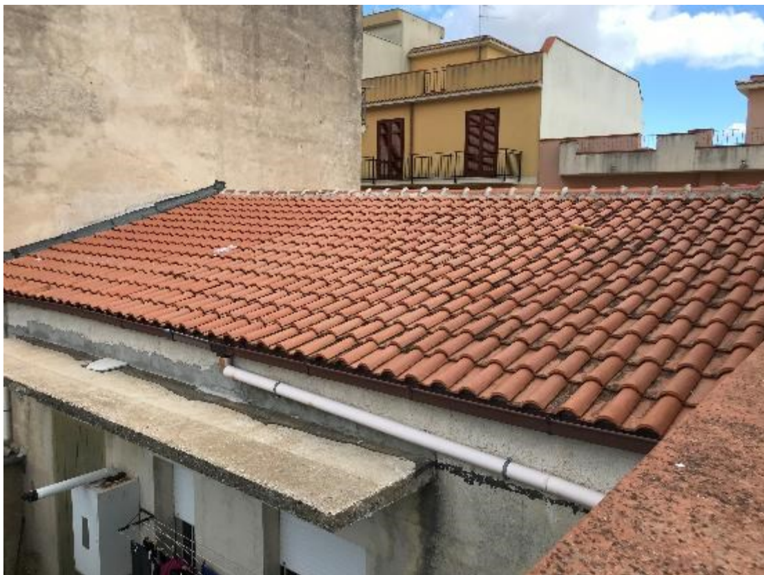
Foto 1.5 – Copertura del fabbricato sito nel Comune di Partanna (TP) in Via Largo Pecorelle n. 17
