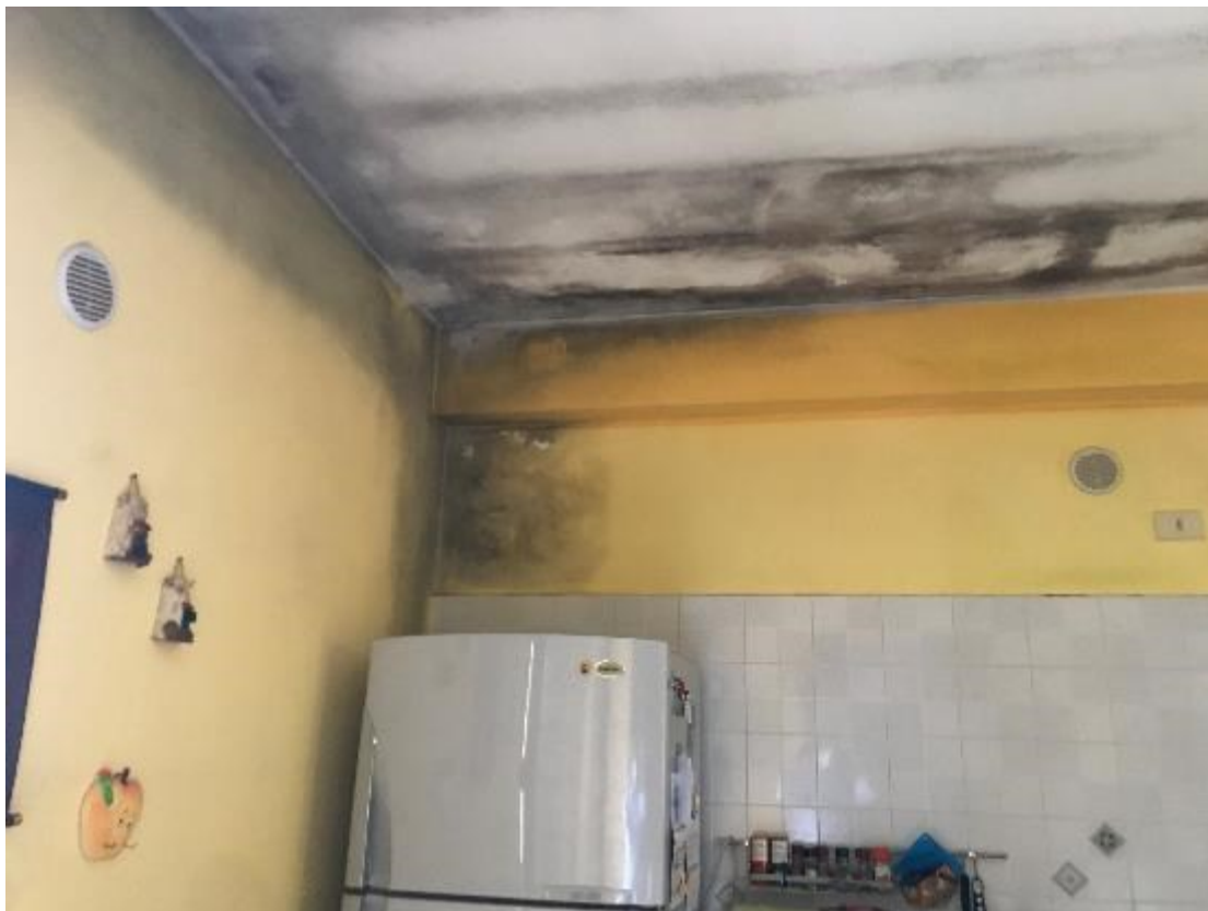
Foto 1.26 – Umidità e muffe degli ambienti del fabbricato di Via Largo Pecorelle n. 17
