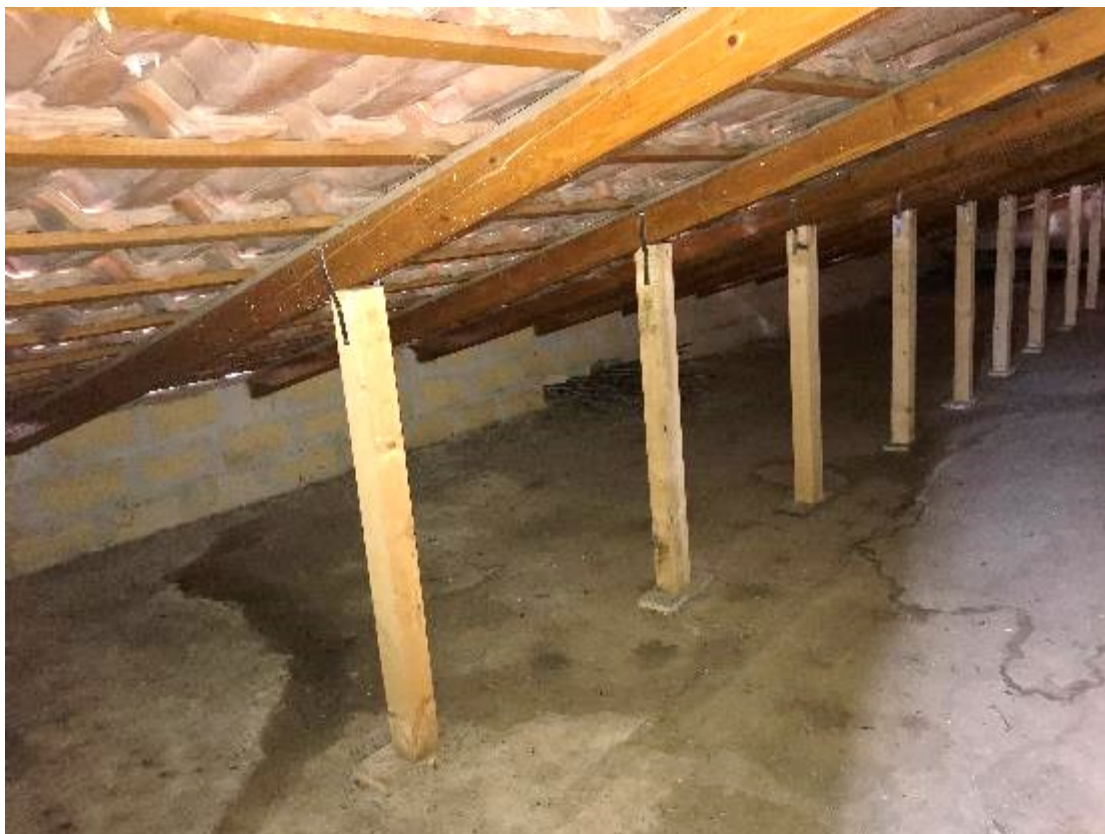
Foto 1.25 – Particolare della copertura delle due falde inclinate del fabbricato di Via Largo Pecorelle n. 17
