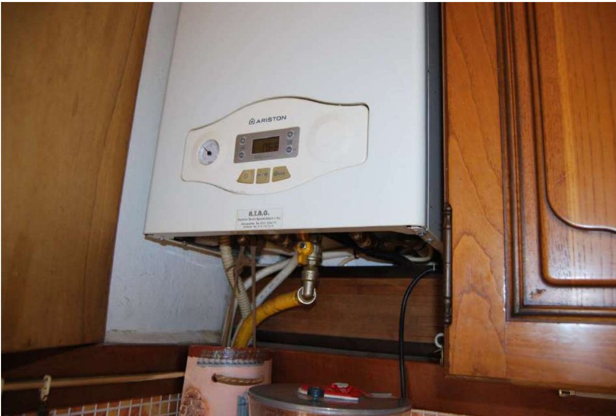
Cucina e caldaia a metano foto 9-10)
