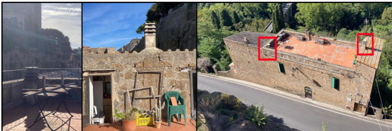
Impianto riscaldamento: canne fumarie per le due stufe
