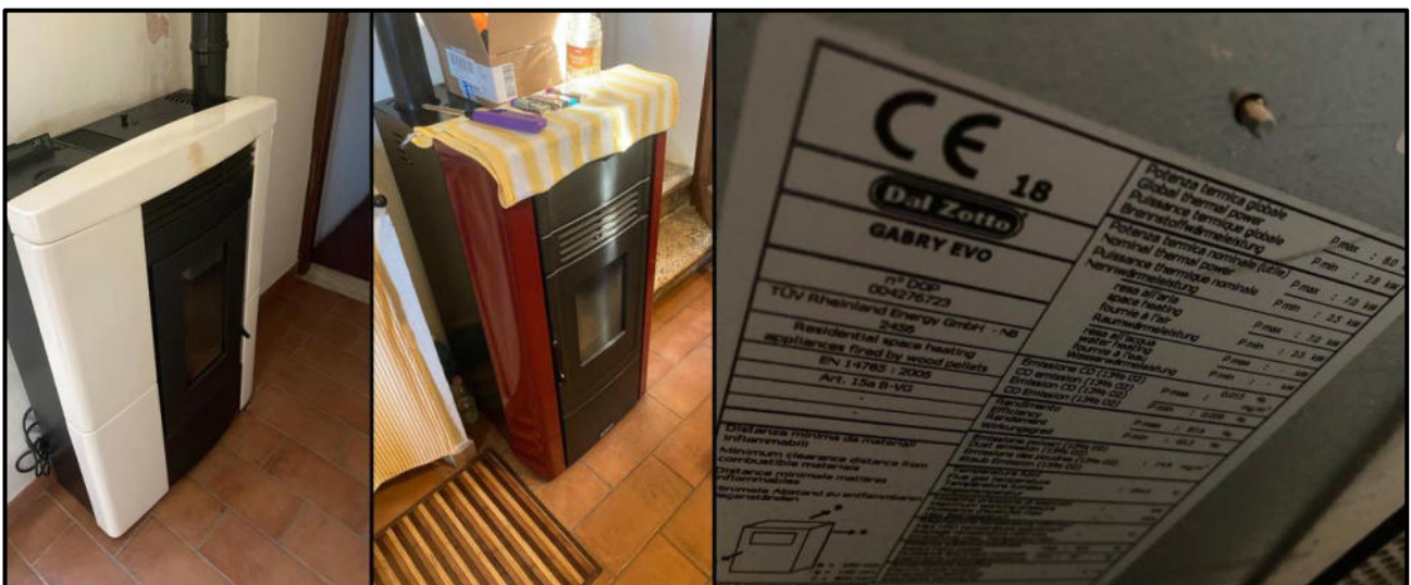
Impianto riscaldamento: stufe a pellet presenti nell'immobile
