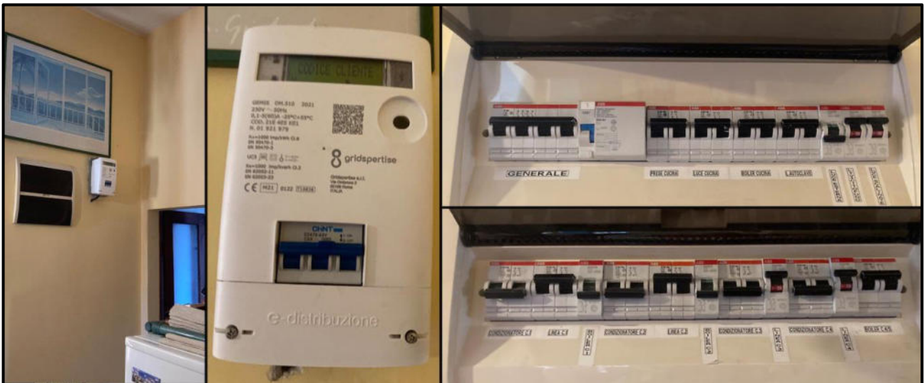
Impianto elettrico: punto di fornitura con alloggiamento contatore e quadro generale
