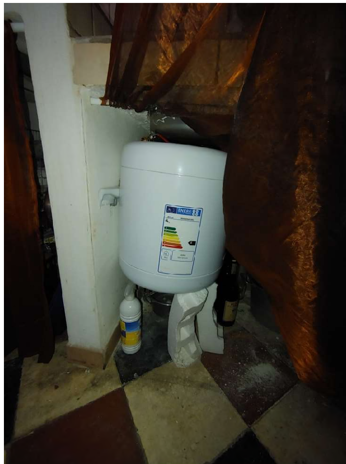
Foto C22 - LOTTO 1 - SCALDACQUA ELETTRICO
