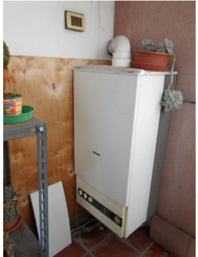
Foto 16: caldaia installata nel poggiolo
