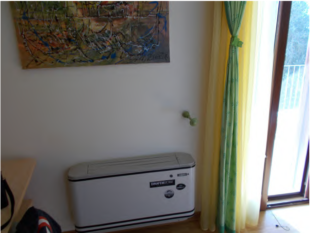
IMPIANTO DI RISCALDAMENTO AL 1° P.
