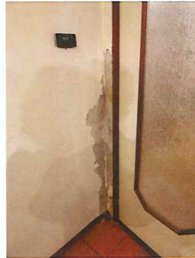
Foto 12) Part. degrado muratura perimetrale esterno
