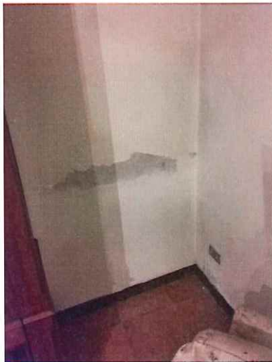
Foto 11) Part. degrado muratura perimetrale esterna
