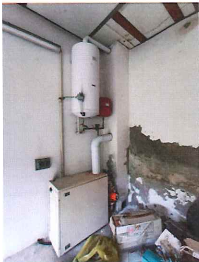
Foto 27) Part. interno – Caldaia e boiler
