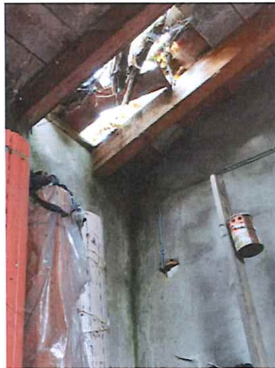
Foto 28) Part. interno – Crollo parziale della copertura
