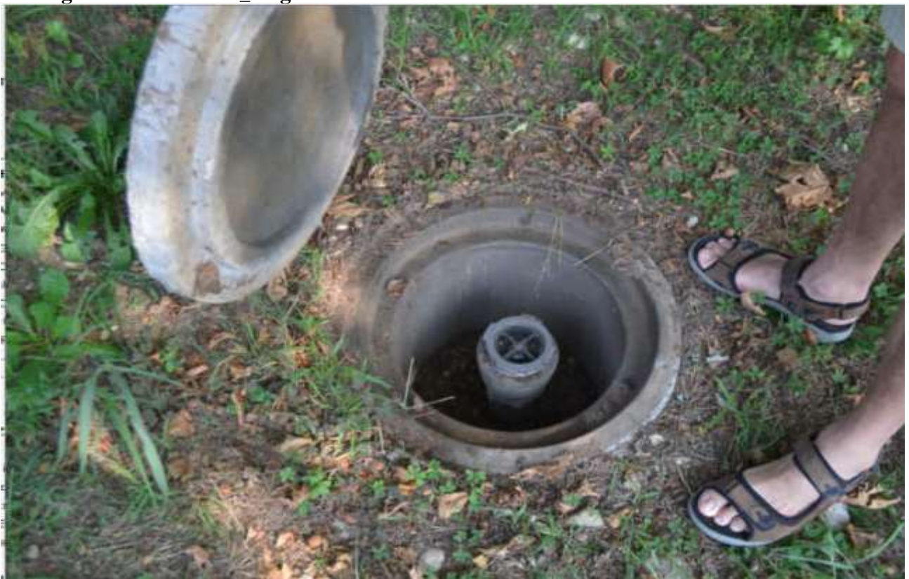
Figura 13 - Sarcedo_ Foglio: 12 Particella: 153-PRESA D'ACQUA-IRRIGAZIONE
