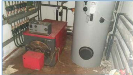
locale centrale termica
