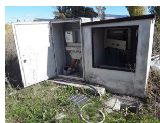
Contatore di produzione/contatore di scambio e quadro generale
