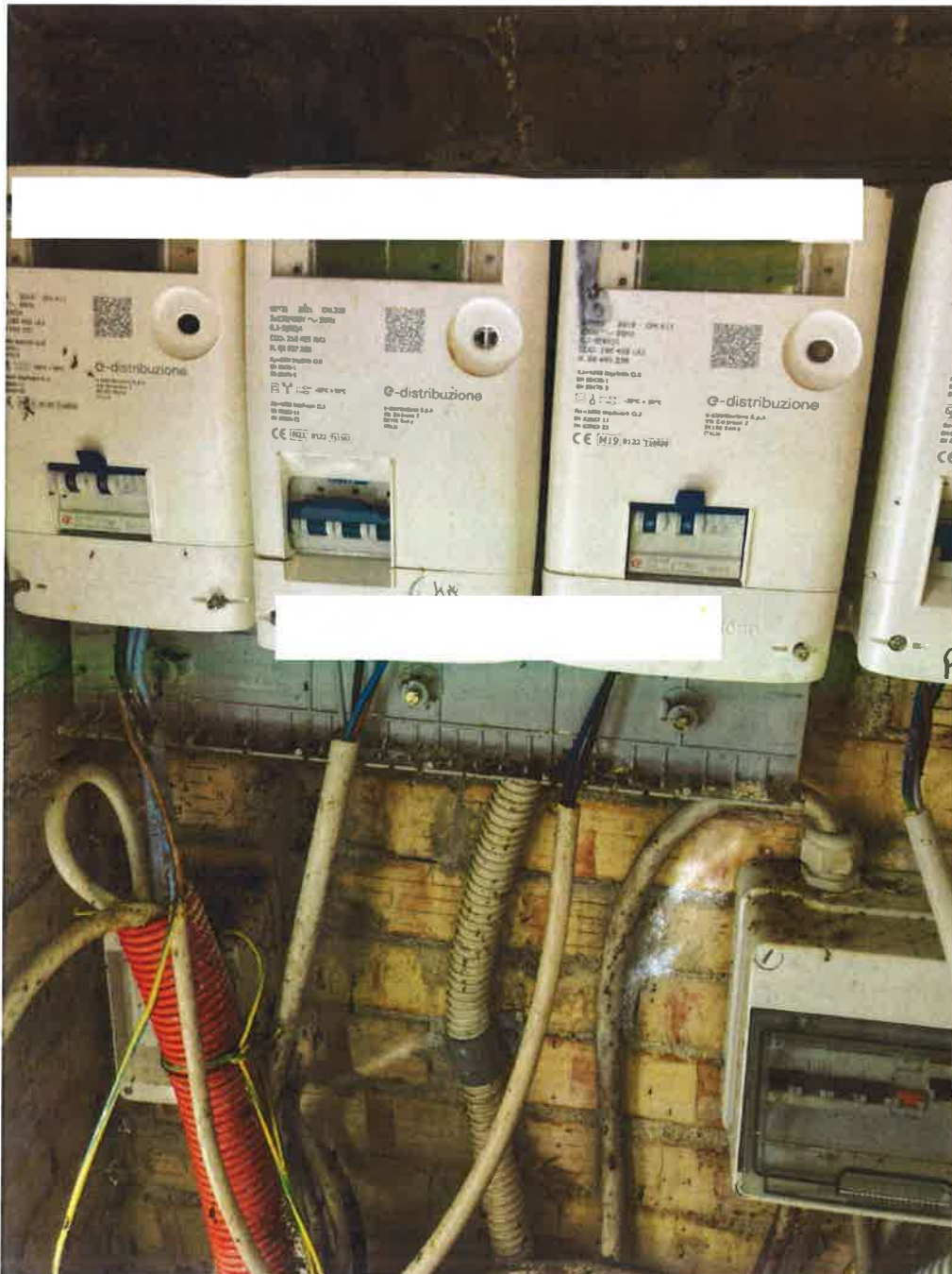
FOTO 22– PARTICOLARE DEL MADONNINO CON I CONTATORI ENERGIA ELETTRICA IN PROSSIMITA' DELLA PROPRIETA'
