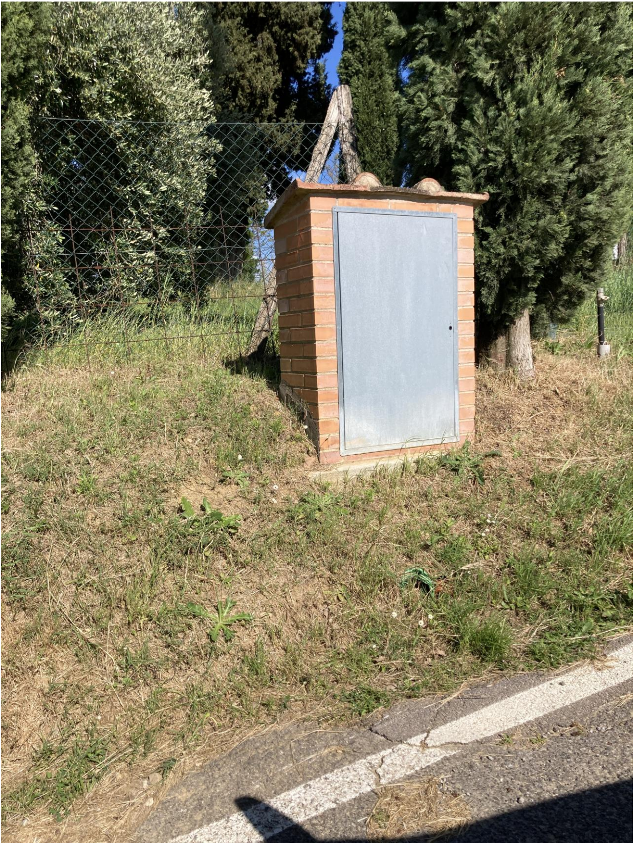
FOTO 24– PARTICOLARE DEL MADONNINO CON IL CONTATORE ACQUEDOTTO ALL'INIZIO DELLA STRADA VICINALE
