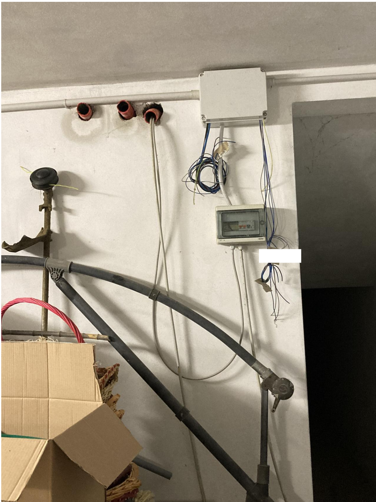
FOTO 28– PARTICOLARE IMPIANTO ELETTRICO DA ULTIMARE ALL'INTERNO DEL GARAGE
