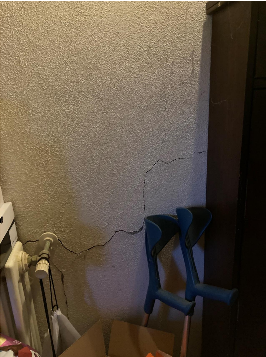
FOTO 17– PARTICOLARE DELLE LESIONI PRESENTI SULLA PORZIONE DI FABBRICATO ADIACENTE ALL'INGRESSO
