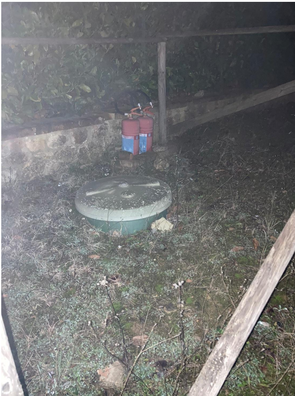
FOTO 21– VISTA DEL SERBATOIO GPL AL LIMITE DELLA PROPRIETA’
