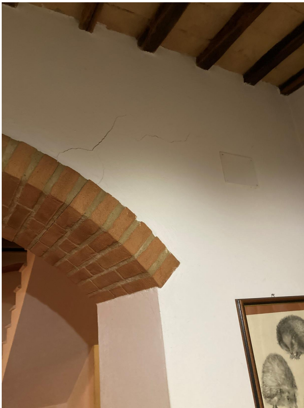
FOTO 20– PARTICOLARE DELLE LESIONI PRESENTI SUL FABBRICATO IN PROSSIMITA' DELL'INGRESSO
