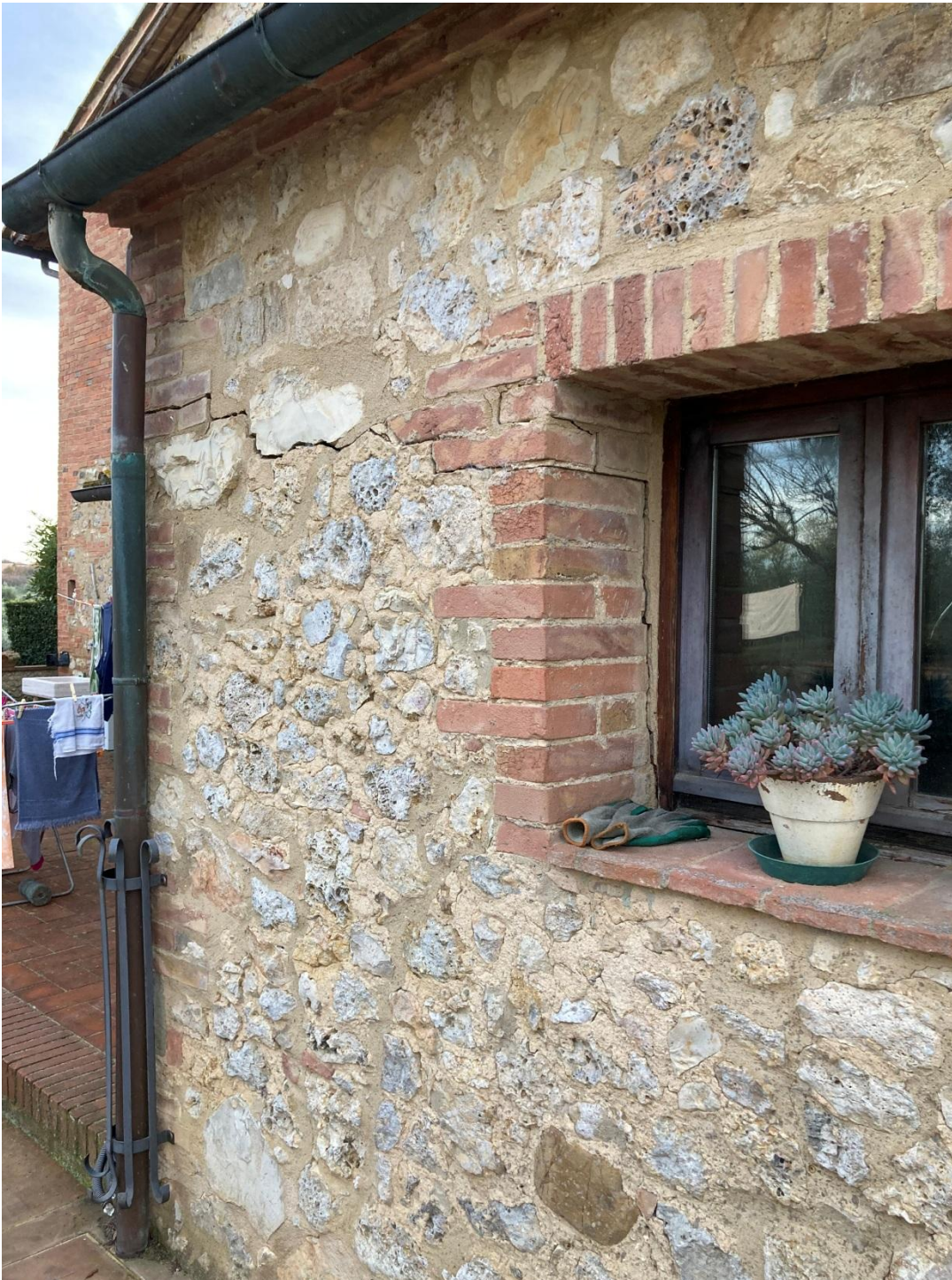
FOTO 16– PARTICOLARE DELLE LESIONI PRESENTI SULLA PORZIONE DI FABBRICATO ADIACENTE ALL'INGRESSO
