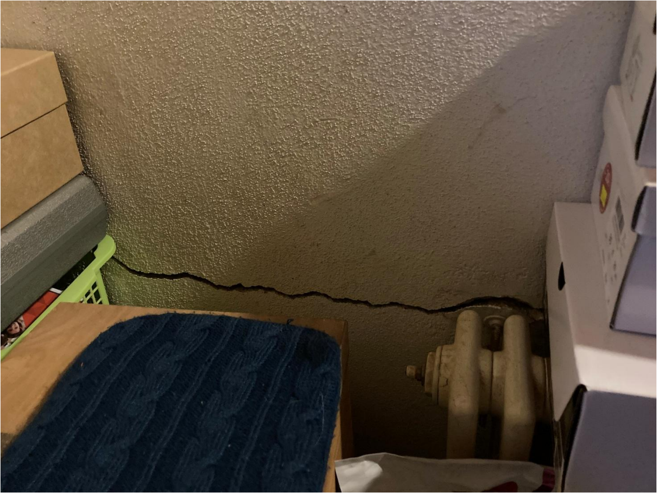
FOTO 18– PARTICOLARE DELLE LESIONI PRESENTI SULLA PORZIONE DI FABBRICATO ADIACENTE ALL'INGRESSO
