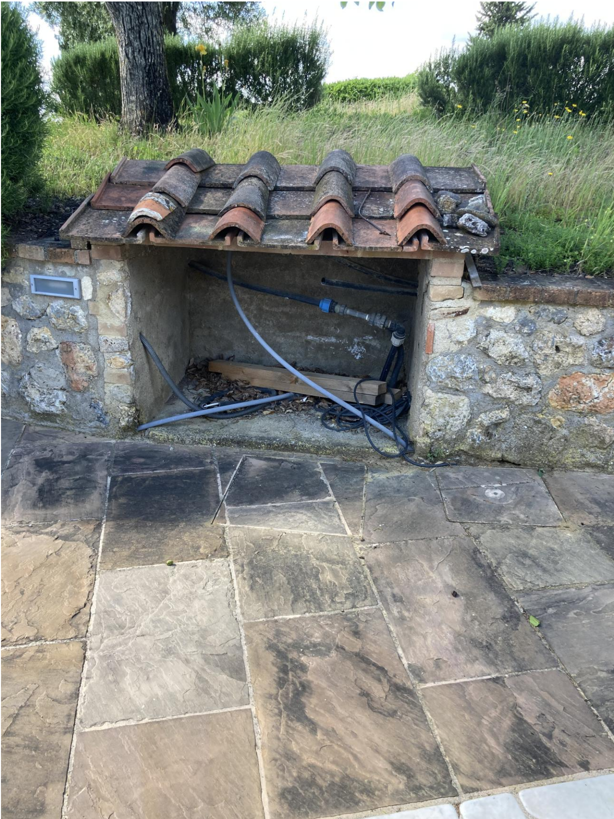
FOTO 25– PARTICOLARE DEL MADONNINO CON LA PREDISPOSIZIONE POMPA PER RECUPERO ACQUA PIOVANA DEI TETTI ALL'INTERNO DELLA PROPRIETÀ
