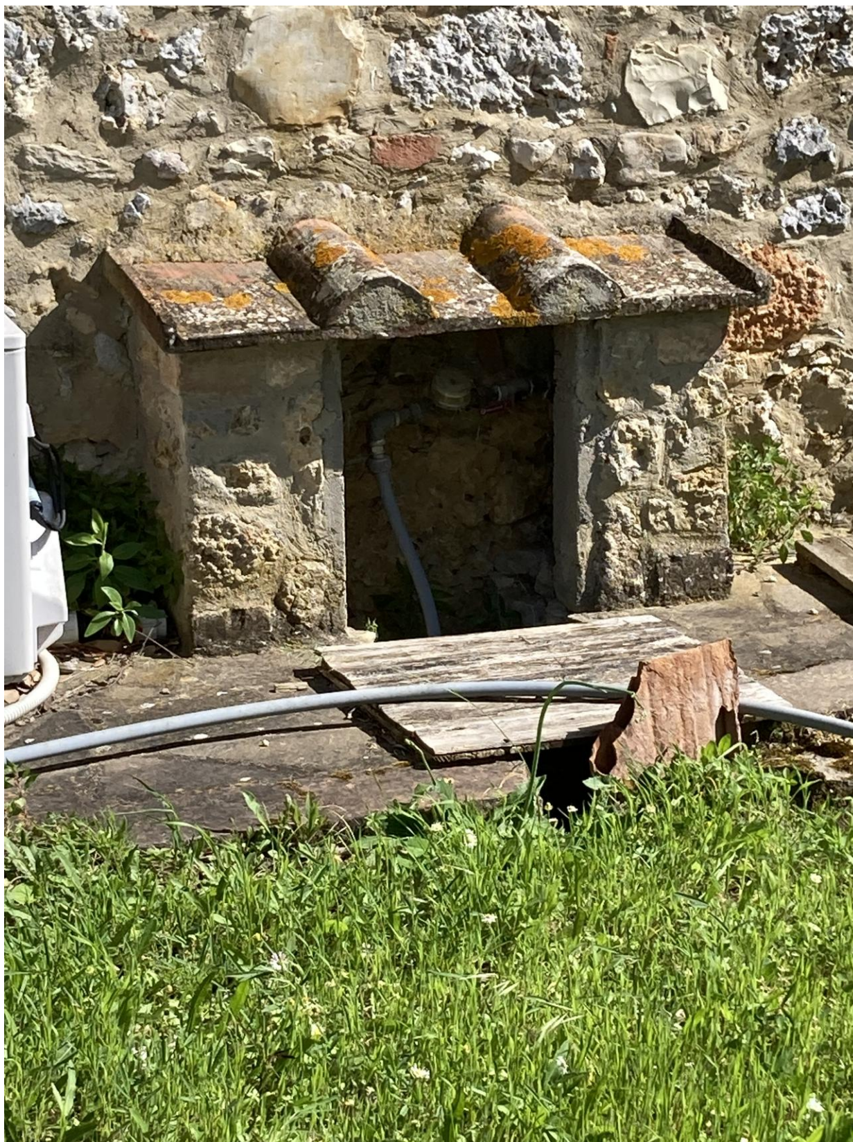
FOTO 23– PARTICOLARE DEL MADONNINO CON IL CONTATORE ACQUEDOTTO (SOTTOCONTATORE?) ALL'INTERNO DELLA PROPRIETÀ
