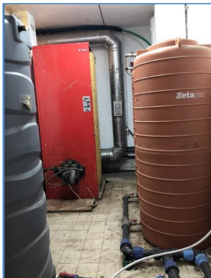
Foto n°74 - locale tecnico lato sinistro - n.1
