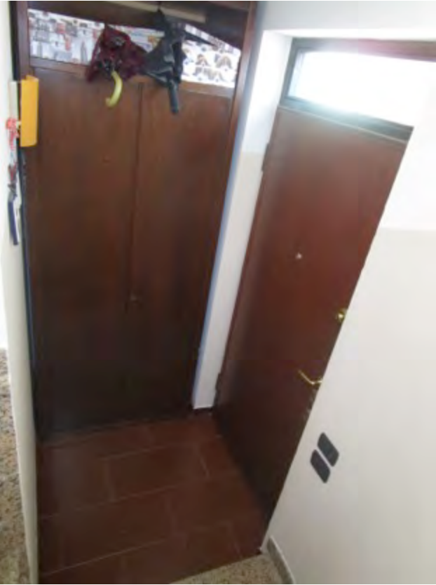
35. Ingresso a P.T. per sub. 3.
