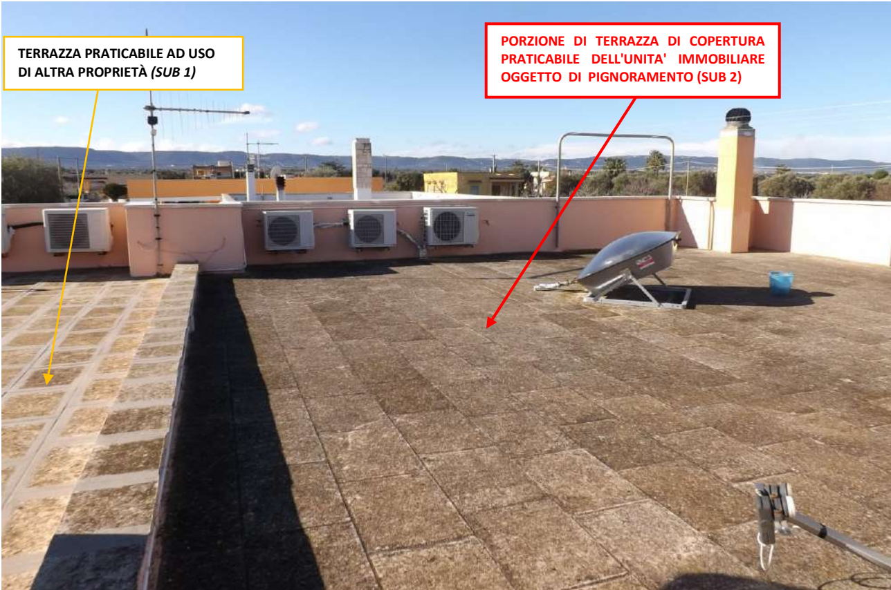
Foto 18_ Altra vista della porzione di terrazza praticabile del fabbricato bifamiliare a copertura dell'unità immobiliare oggetto di pignoramento.
