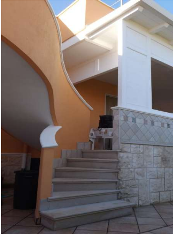
Foto 8_ Vista di dettaglio della struttura in legno realizzata sul prospetto nord-est e della scala scoperta, che consente di superare il dislivello fra il piano di pavimento dell'abitazione e l'area pertinenziale pavimentata. Dalla foto è possibile constatare che il prolungamento dell'orinaria porzione aggettante della terrazza di copertura del fabbricato, è stato realizzato mediante la costruzione una pensilina in legno aggettante, sostenuta da una struttura verticale costituita da montanti e pannelli in legno agganciati al parapetto esistente.
