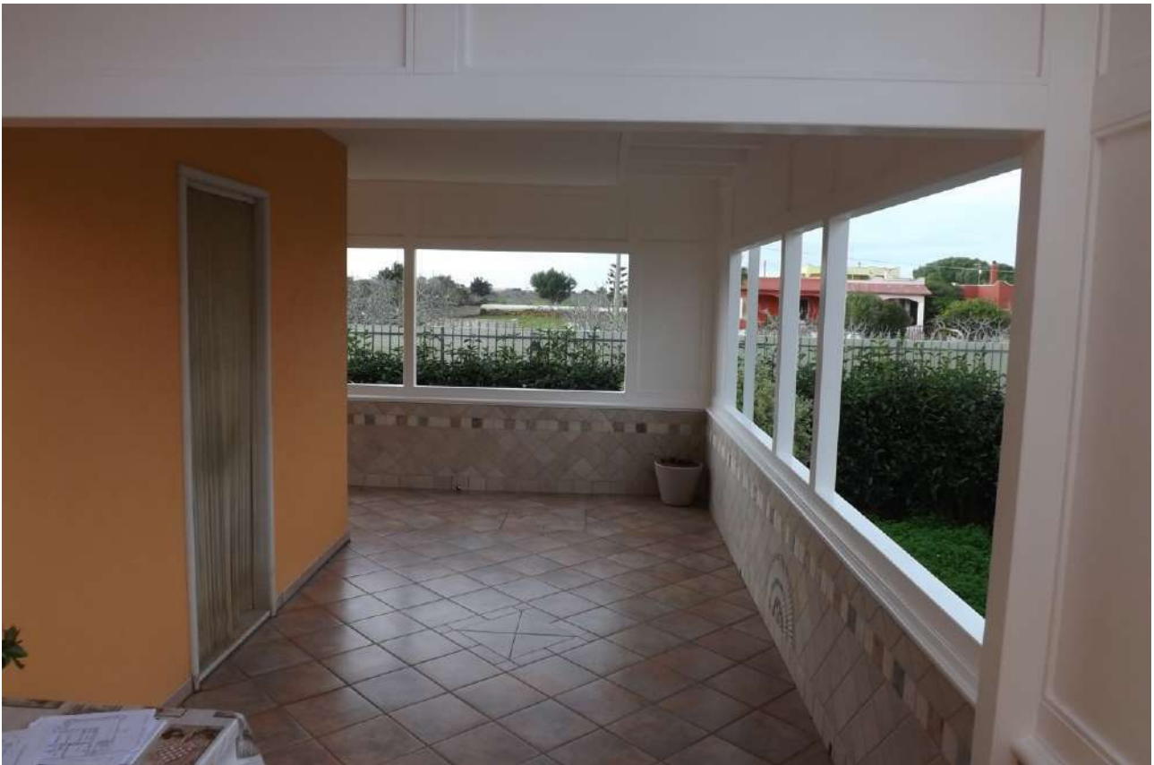
Foto 14 Altra vista della porzione di veranda prospiciente il prospetto nord-est e dalla quale si accede alla cucina dell'unità immobiliare.
