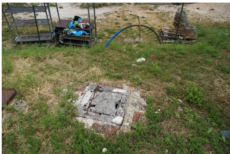
Foto n°14: particolare dell'alloggiamento del contatore dell'acqua posto lungo la zona a Sud dello stabile.
