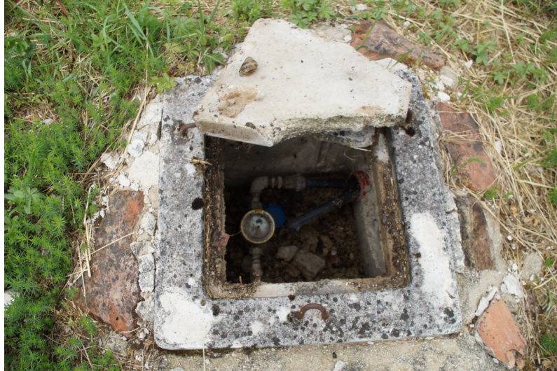
Foto n°15: altro particolare del contatore dell'acqua.
