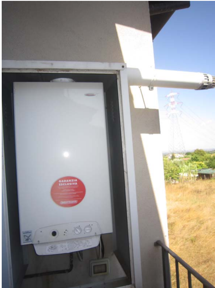
Foto 14 – Vista della caldaia nel terrazzino posteriore
