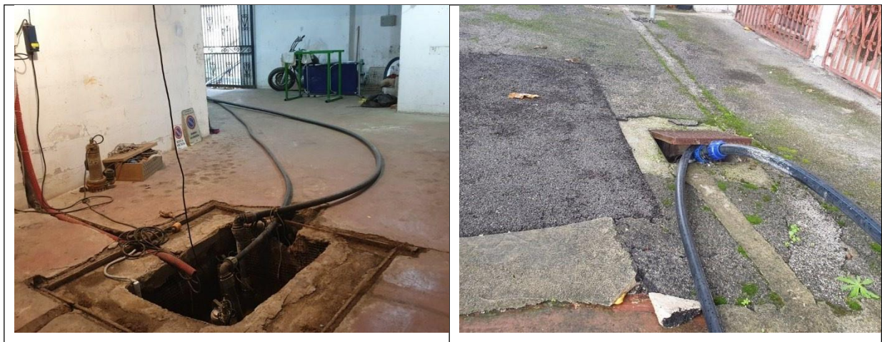
Figura 5 - Sistema di drenaggio precario
