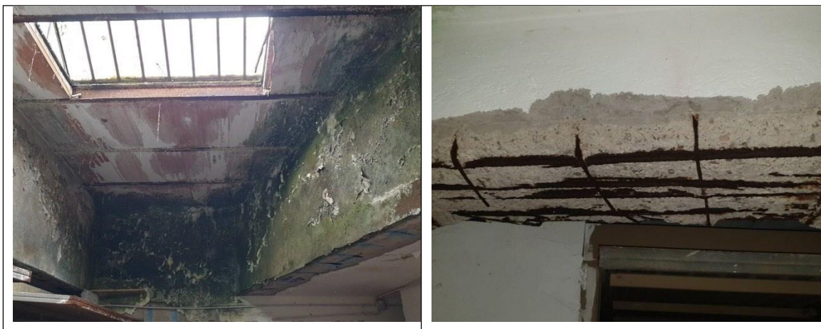
Figura 6 - Infiltrazioni e ammaloramenti
