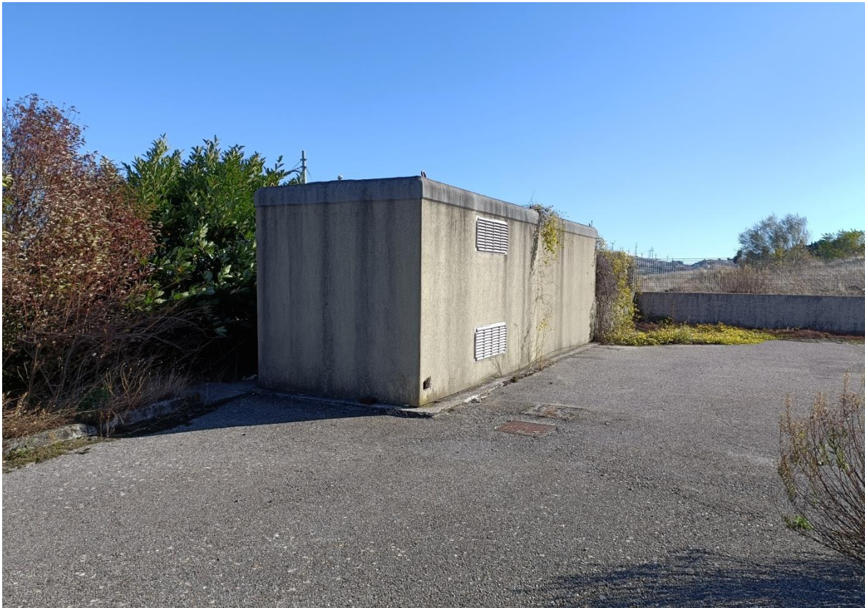
Figura 3 – Panoramica Cabina di Trasformazione.
