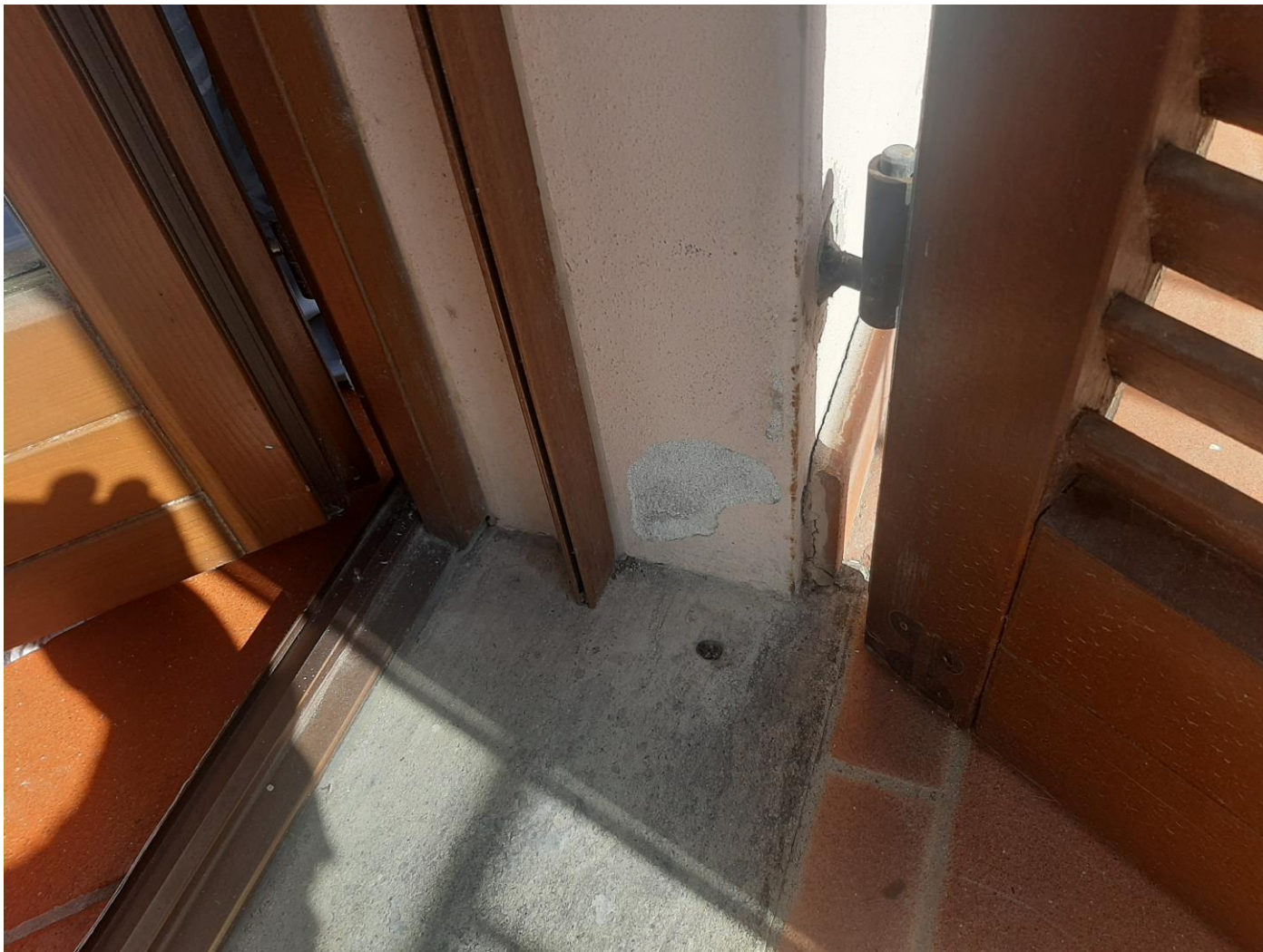
Foto n. 2 – umidità di risalita
