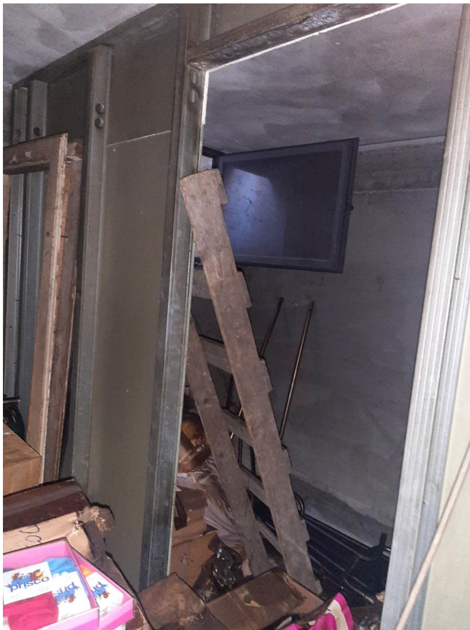
Foto n. 31 - interno con vista su parete abusiva
