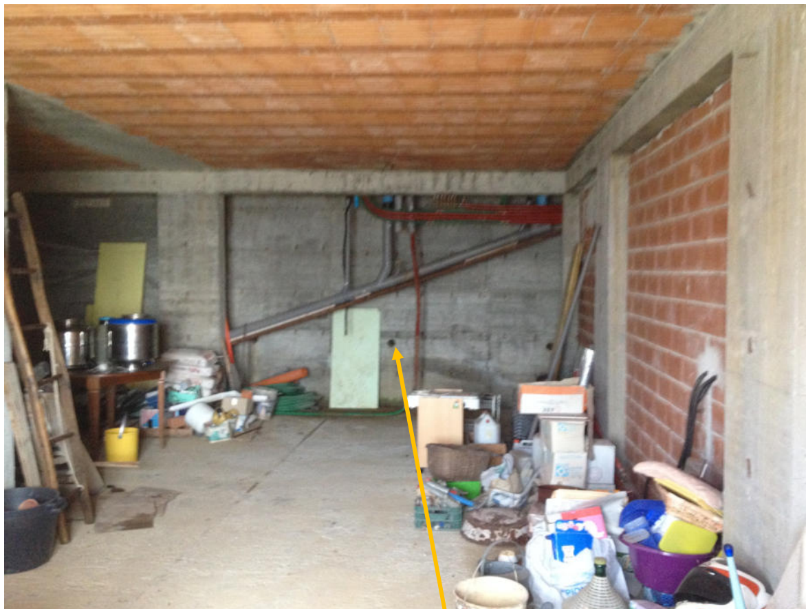
FOTO 26 - Bene n. 2: Magazzino, non ancora ultimato, si presenta a rustico . manca tramezzo di separazione dall'intercapedine
