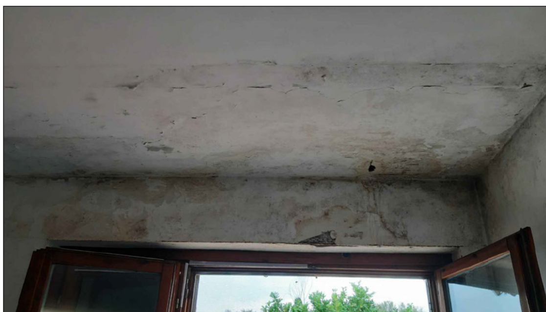
foto 10 - infiltrazioni dalla copertura sul soffitto e parete del soggiorno.
