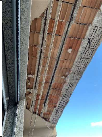
VISTA ESTERNA NEGOZIO (Cespite 3) PENSILINA ESTERNA CON CADUTA INTONACI
