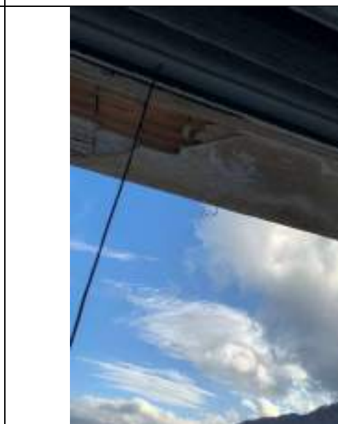
VISTA ESTERNA NEGOZIO (Cespite 3) PENSILINA ESTERNA CON CADUTA INTONACI
