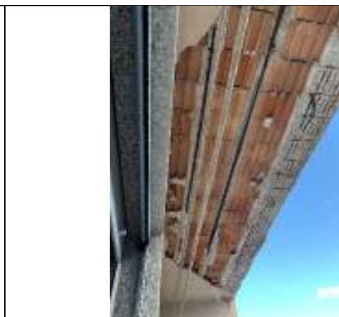
VISTA ESTERNA NEGOZIO (Cespite 3) PENSILINA ESTERNA CON CADUTA INTONACI
