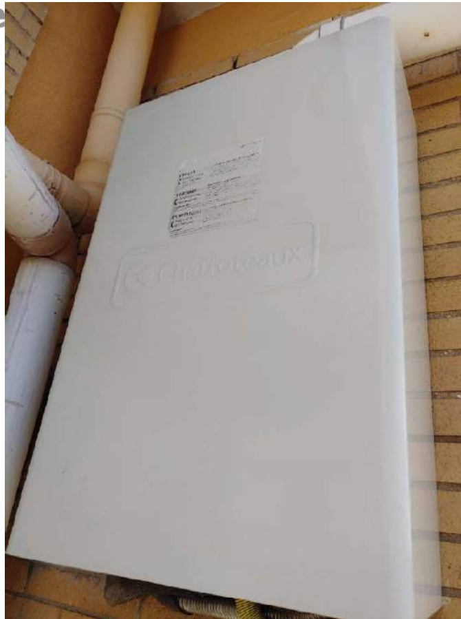
Foto C21 - APPARTAMENTO PIANO ATTICO - CALDAIA ESTERNA
