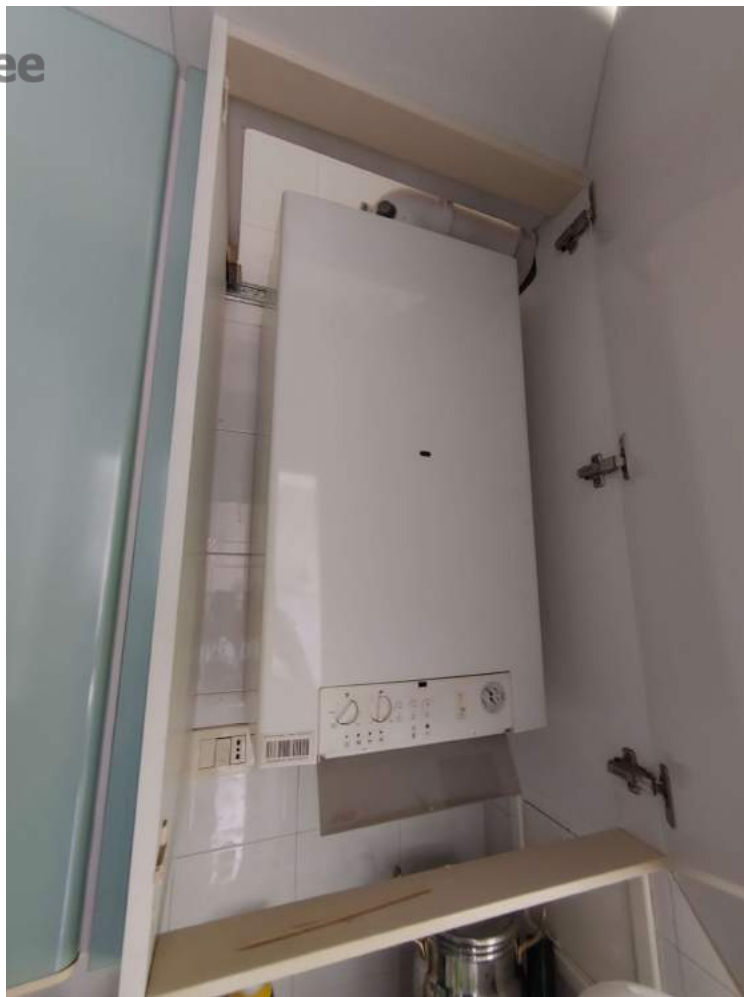
Foto C9 - APPARTAMENTO II PIANO ATTICO - CUCINA - CALDAIA
