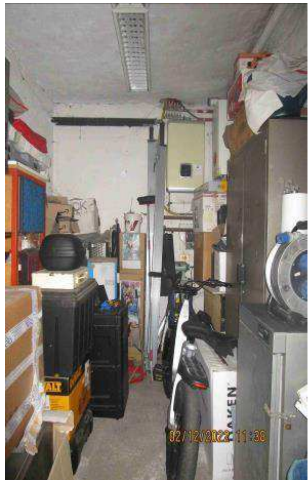
Centrale termica PT
