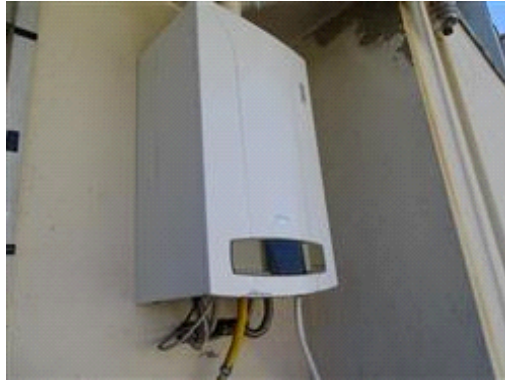
Caldaia impianto riscaldamento piano primo
