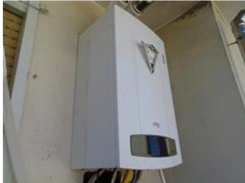
Caldaia impianto riscaldamento piano secondo
