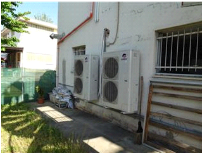
Piano terra pompe di calore
