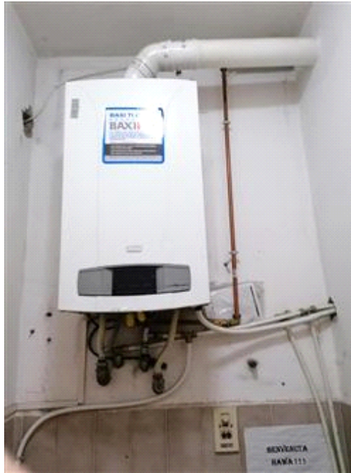
Caldaia impianto riscaldamento Ufficio
