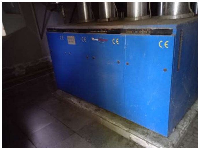
Foto n. 80 – Immobile D - Locali tecnici
