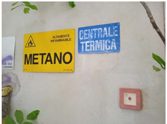
Foto n. 78 – Immobile D - Locali tecnici
