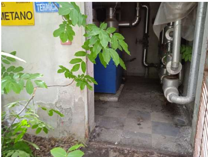
Foto n. 79 – Immobile D - Locali tecnici
