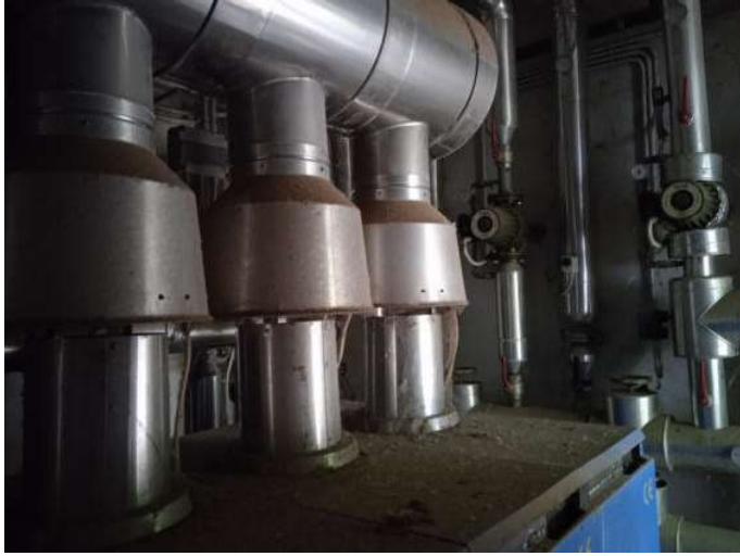
Foto n. 81 – Immobile D - Locali tecnici
