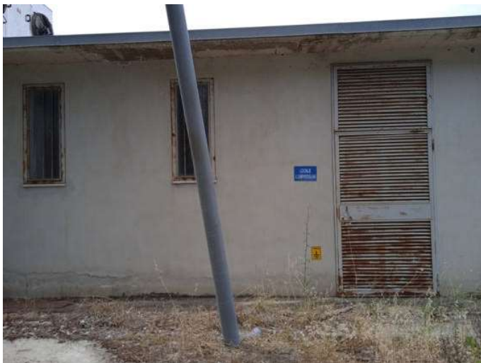
Foto n. 77 – Immobile D - Locali tecnici
