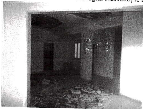
Pranzo soggiorno con soffitto crollato
