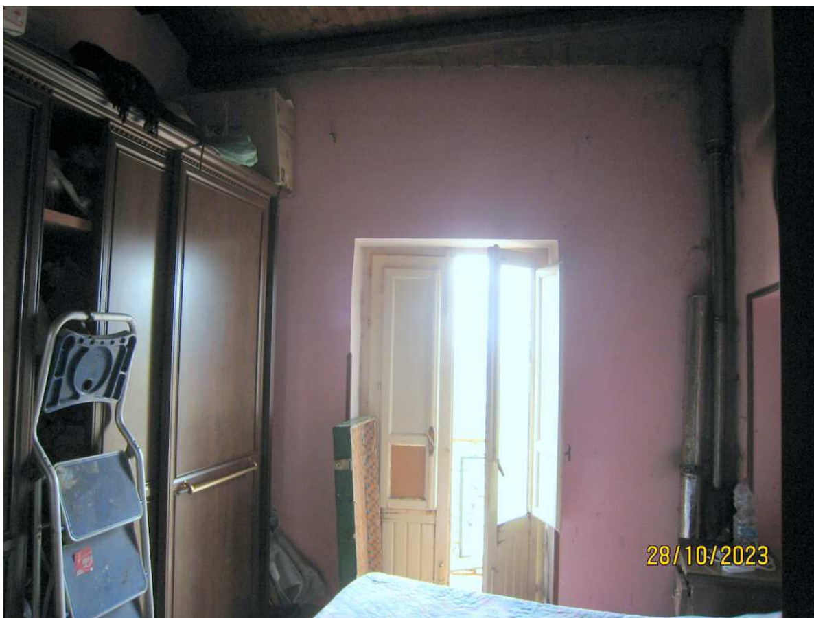
Foto n. 56. La parete lungo la canna fumaria è danneggiata dal calore e da fenomeni di condensa.
