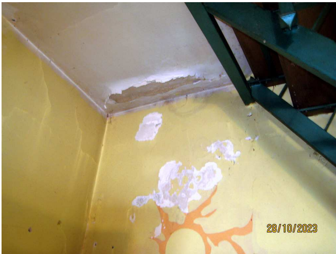
Foto n. 66. Umidità sulla parete contro il terrapieno di Via S. Antonio.
