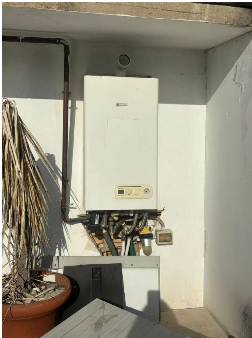
Foto 32 Caldaia Foglio 10 - Part.896 - Sub.19 Piano quarto
