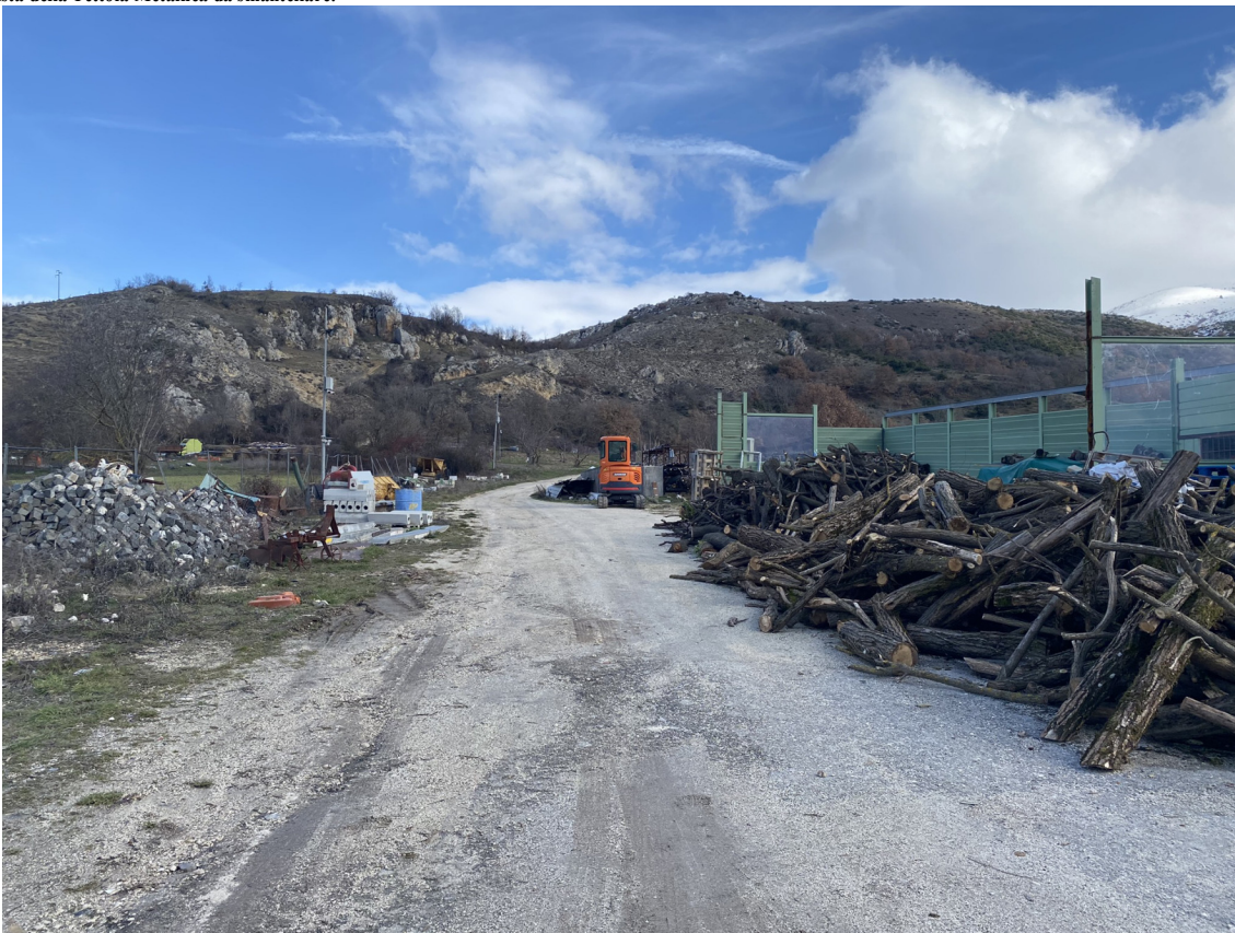
Foto B: Barriere in acciaio e lamiera non coperte per il contenimento di legname da smantellare.
