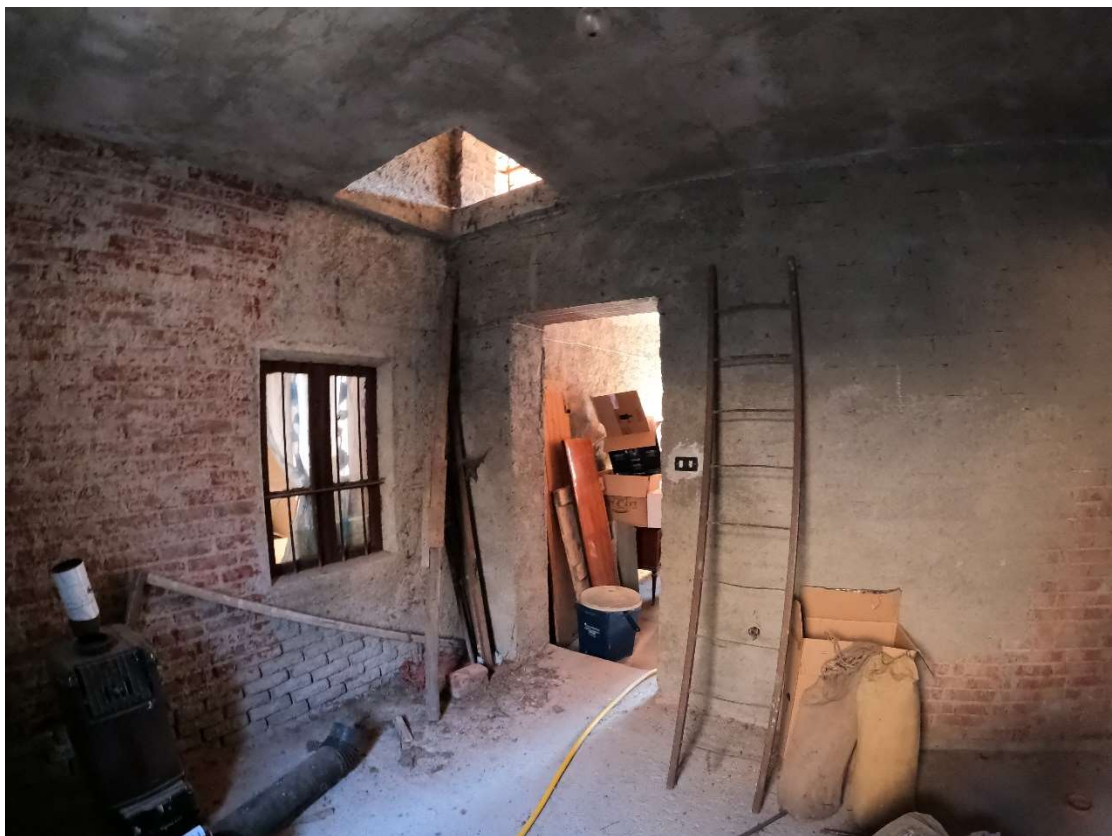
Foto 12 – Bagno da ristrutturare al piano primo
