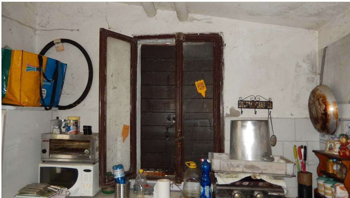
PARTICOLARE INTERNO LOCALE EX LAVANDERIA (MOLTO VETUSTO)
