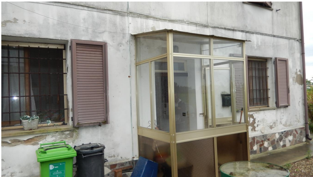
PARTICOLARE BUSOSLA INGRESSO CIV ■ (DIFFORME DA RIMUOVERE)
