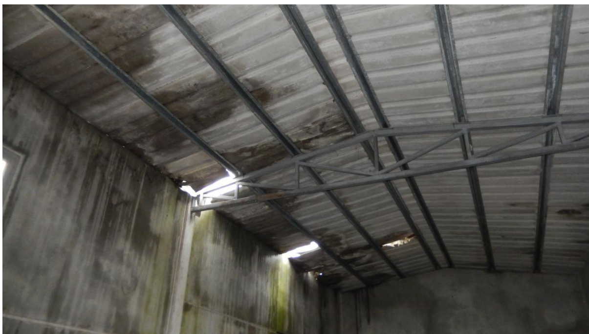
PARTICOLARE COPERTURA E DANNI (ANNOSI) DA FORTUNALE
