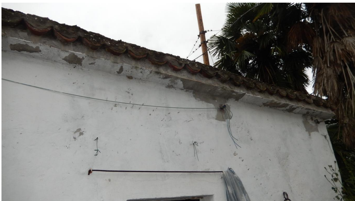
PARTICOLARE COSTRUTTIVO EX LAVANDERIA INFILTRAZIONI PER ASSENZA GRONDAIE E GRMBIALINE
