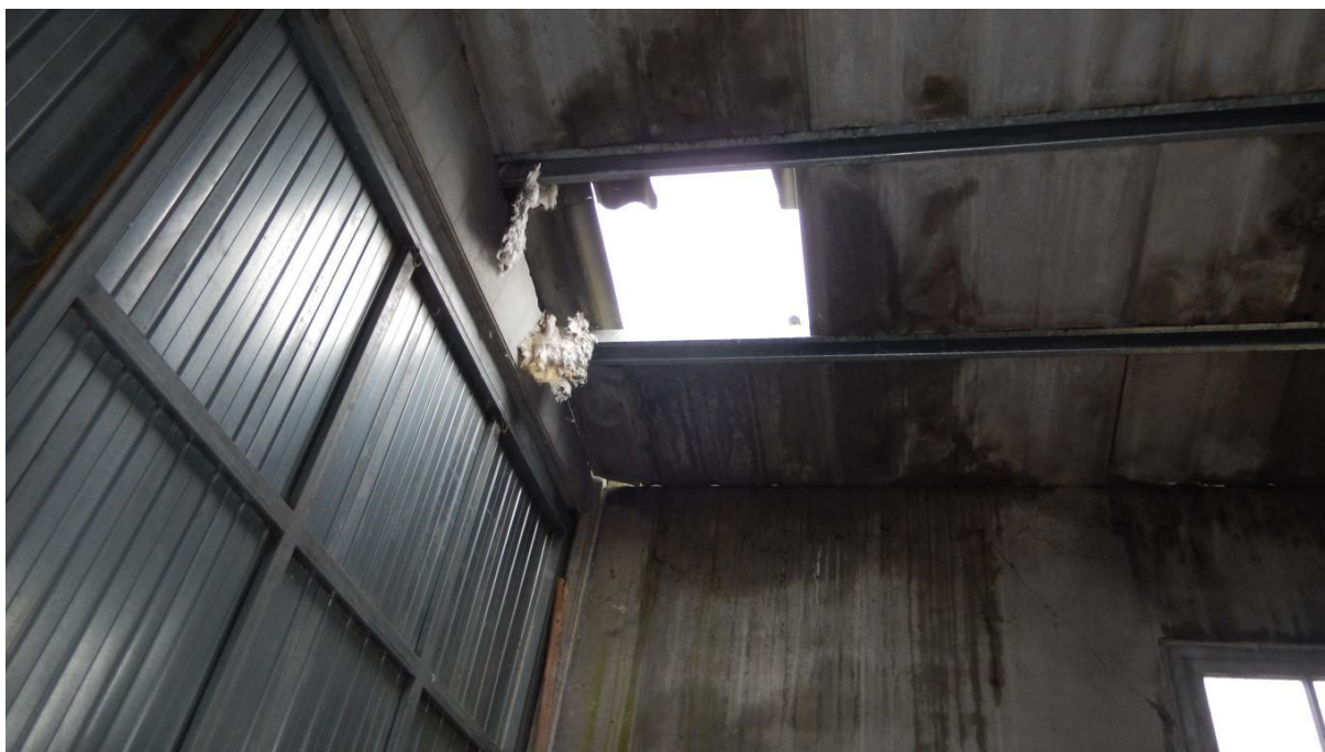
PARTICOLARE DANNI COPERTO
