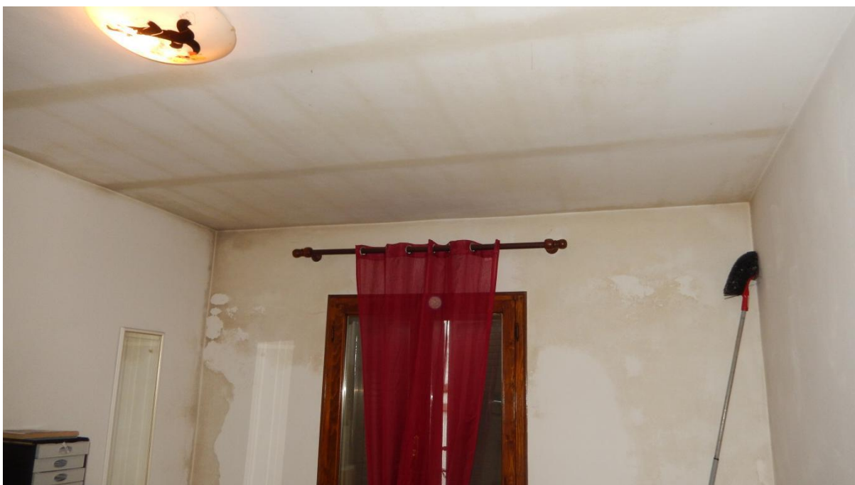
CAMERA INCORPORATA DA ADIACENTE SUB 5 (PARTICOLARE MUFFE DIFFUSE)
