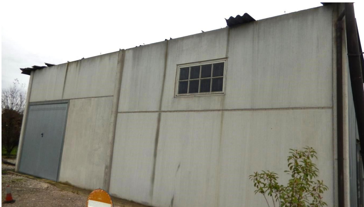
PROSPETTO LATERALE EST CON II° ACCESSO (PARTICOLARE DANNEGGIAMENTO COPERTO)
