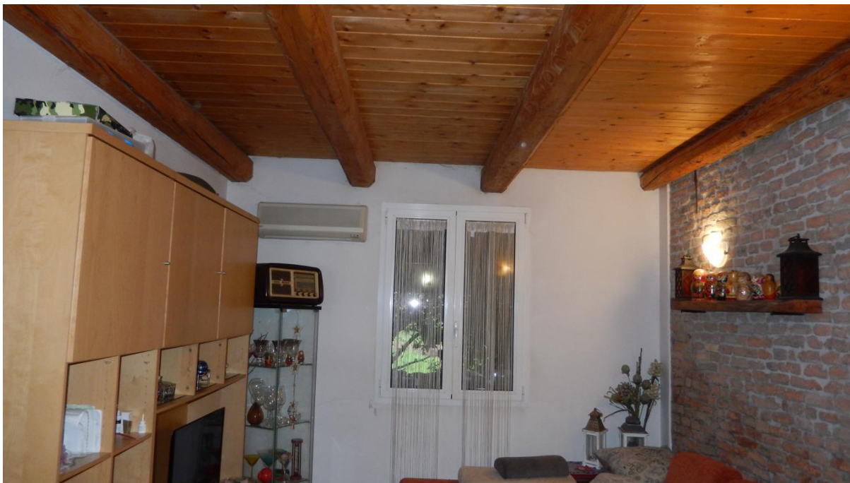
LOCALE P.T.: PARTICOLARE FINESTRA ABUSIVA CON AFFACCIO SU PROPRIETA' DI TERZI (PARTICOLARE SOLAI IN LEGNO LAMELLARE)
