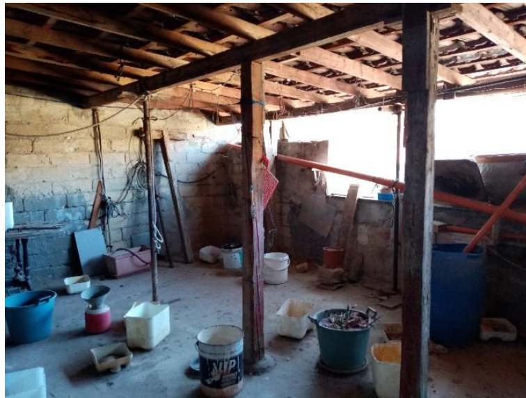
FOTO N° 12 LASTRICO SOLARE CON COPERTURA PRECARIA
