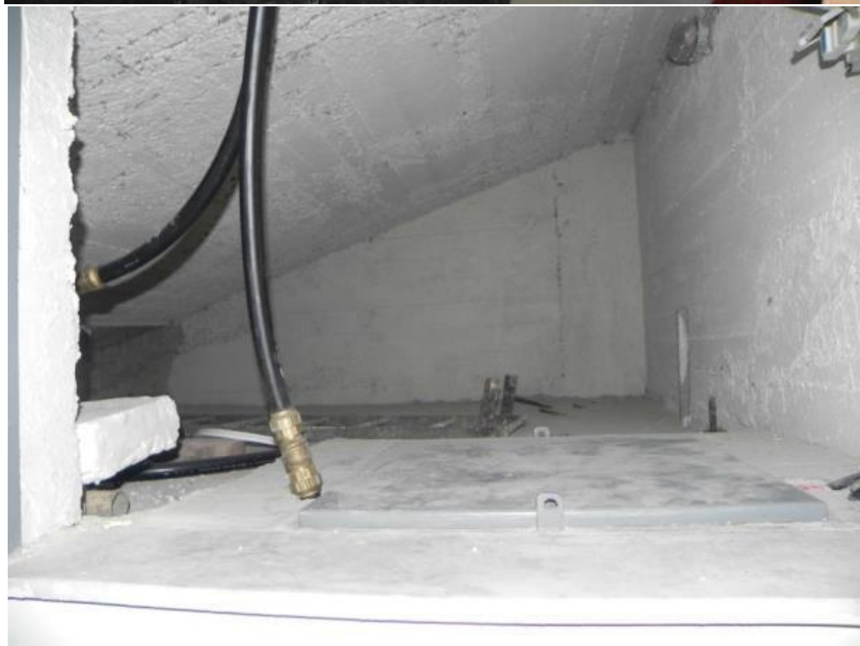
Piano seminterrato - particolare della cisterna collocata nel sottoscala
