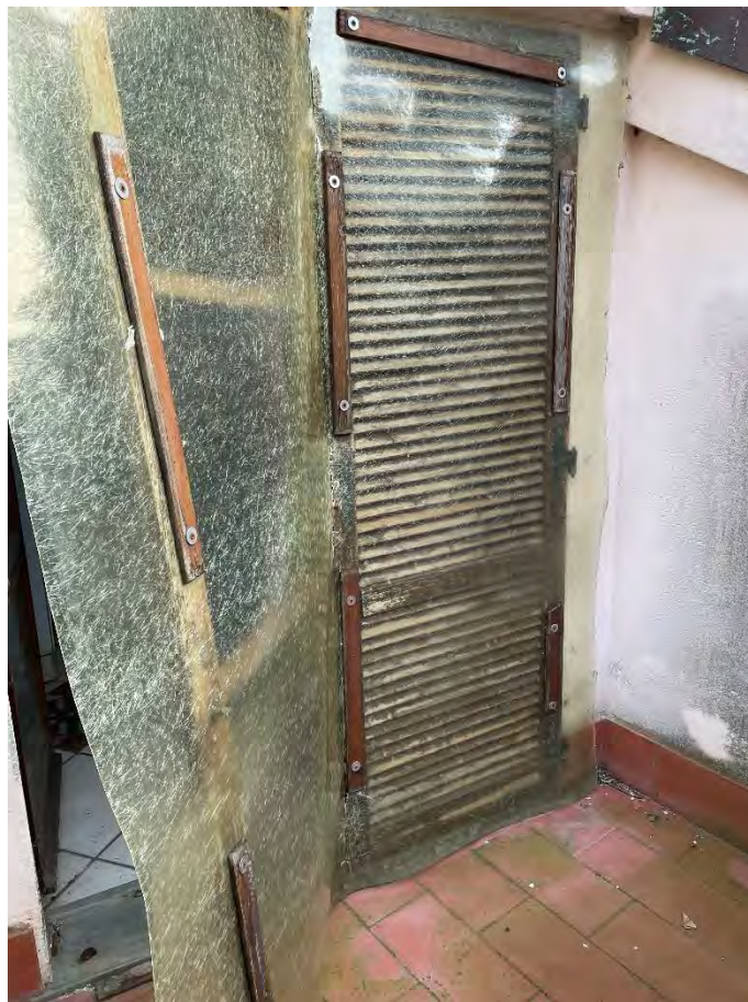
Foto n. 37 – Particolare infisso esterno lastrici solari
