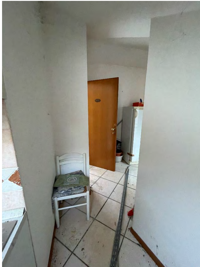
Foto n. 36 – Particolare umidità in corrispondenza del colmo di copertura
