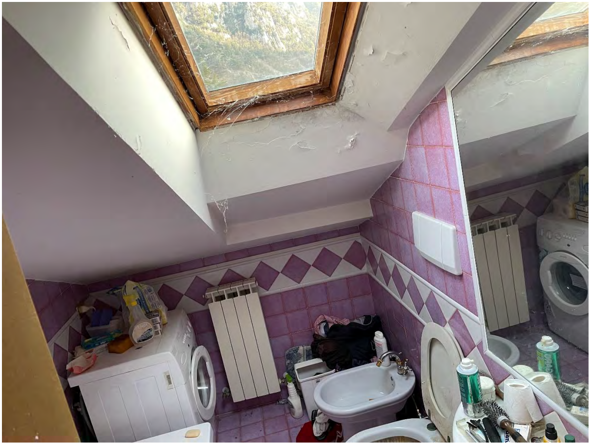
Foto n. 35 – Particolare umidità in corrispondenza della velux
