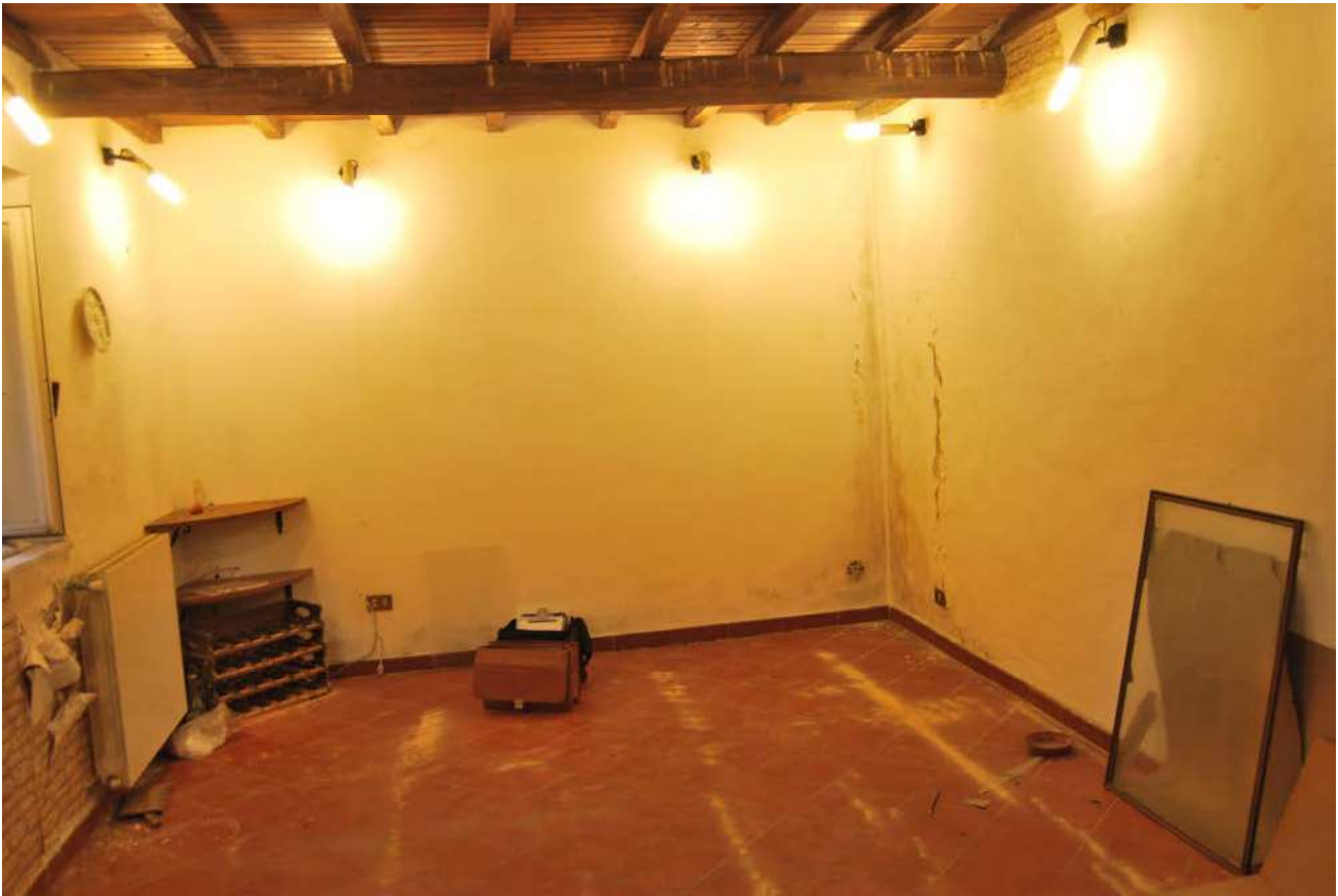
Particolare del pranzo soggiorno al piano primo (n.b. attacco xilofago delle travi lignee)
