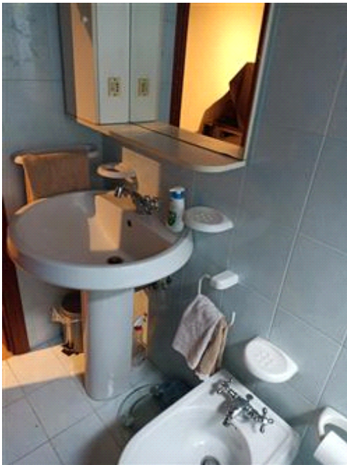
Uno dei bagni, al piano secondo (da rimuovere)
