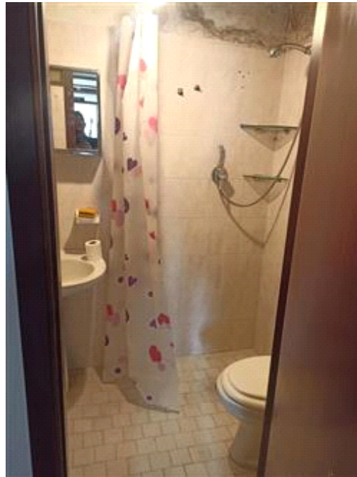
Piano terra: il wc realizzato occupando parte del garage di progetto
